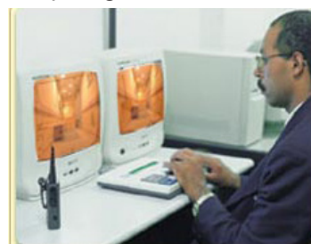
FIG.80 -sala de vigilância em áreas comuns.
