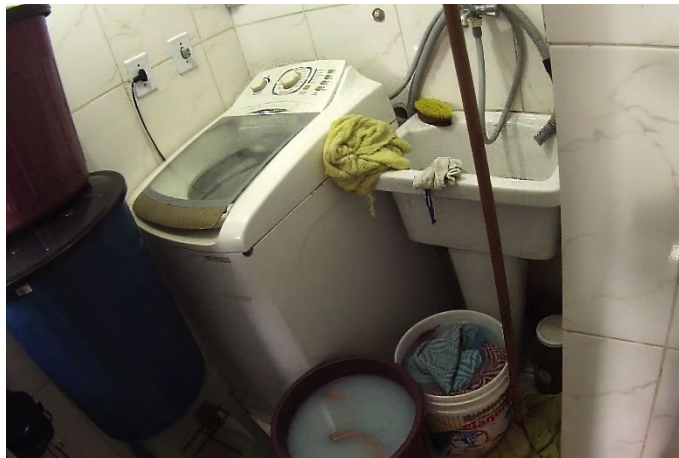
Fig. 37 – tanque e lavadora de roupas
