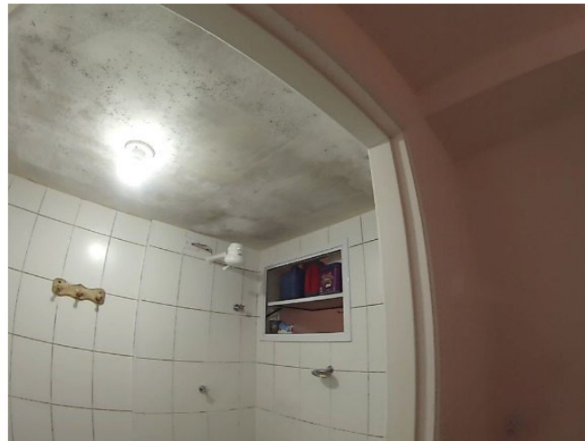
Fig. 10 – o mofo no teto do banheiro
