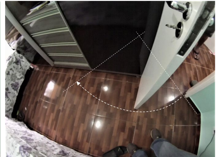
Fig. 25 – piso quarto dos filhos, porta semi obstruída
