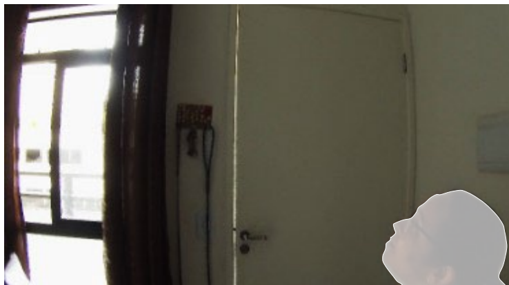
Fig. 42 – o risco de luz que entra pela folga da porta
