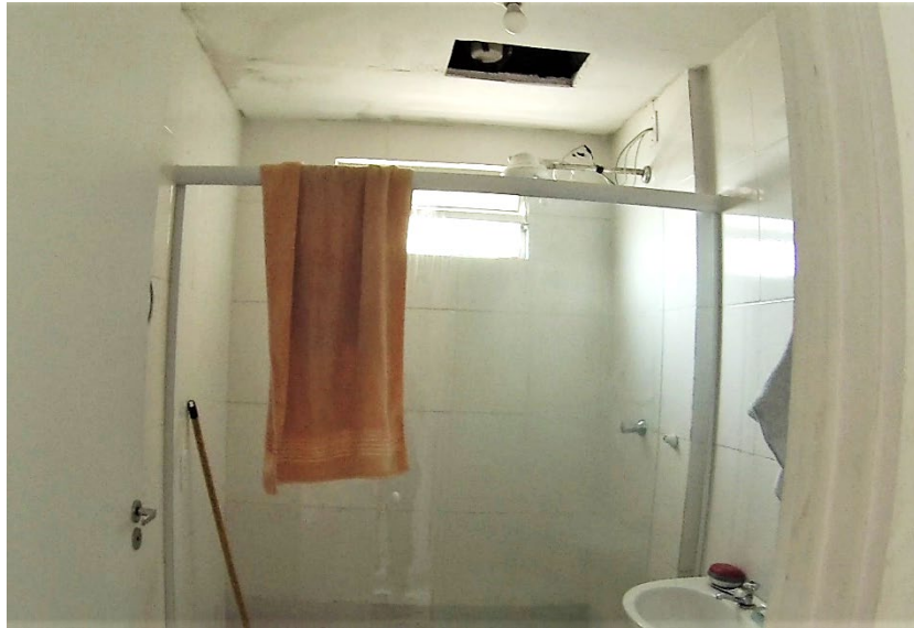
Fig. 20 – o buraco no teto
