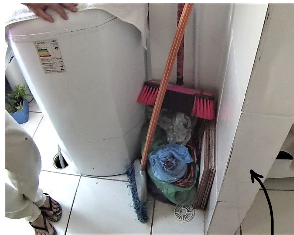
Fig. 7 – descarte de água do tanquinho no ralo descoberto
