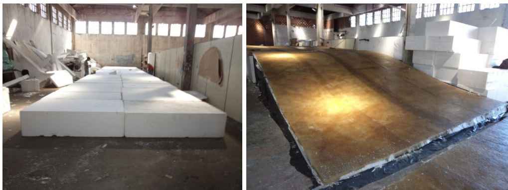
Figura 193. Construção da cobertura do MAR dentro dos barracões de escolas de samba.
