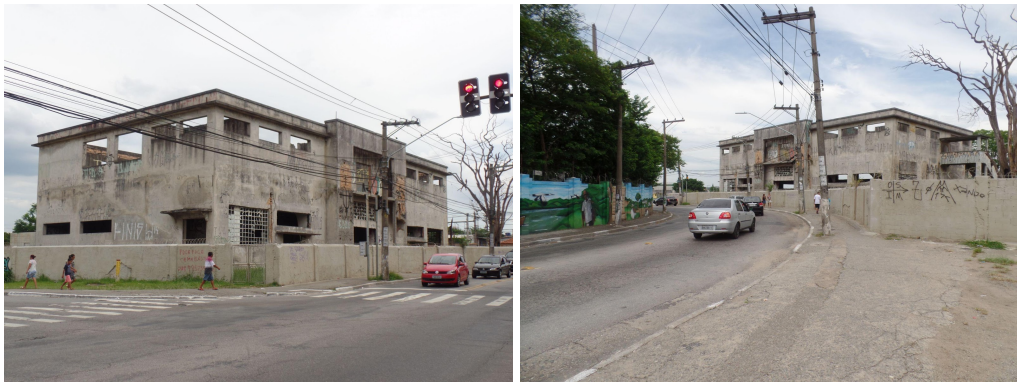
Figura 38. Edifício onde funcionou a Sede Social do Clube da Nitro Química, em profundo estado de deterioração.
