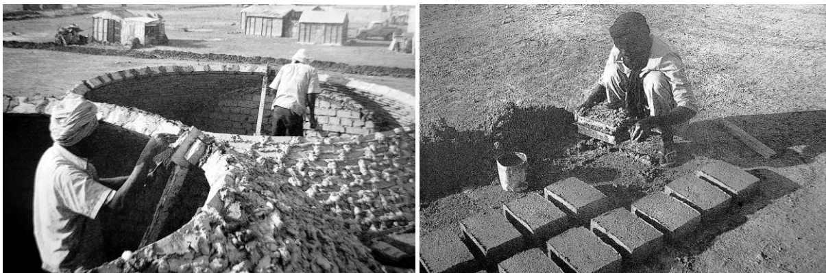
Figuras 72 e 73: Construção de cúpulas sem escoramento e tijolos crus feitos à mão (aos cozidos eram adicionados resíduos de palha de arroz para os tornar mais leves), cidade de Rosso, Mauritânia (fonte: Spazio e Società, n. 68, 1994, p. 91).
