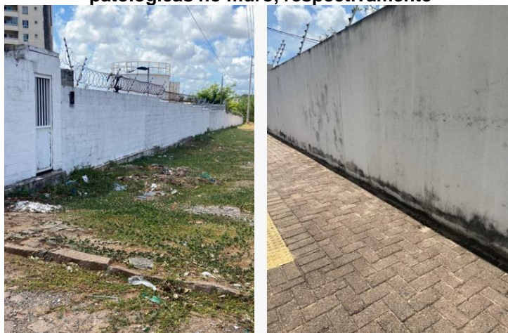
Figura 28: Presença de lixo na área onde deveria ser a calçada e manifestações patológicas no muro, respectivamente
