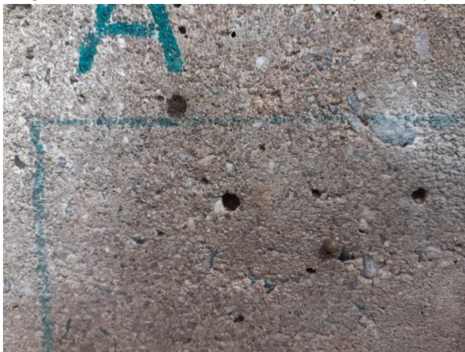
Figura 113 - Resto de inseto retirado de orifício na superfície do pilar.
