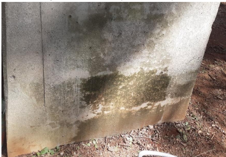
Figura 116 - Biofilme e sujeira na base do pilar.
