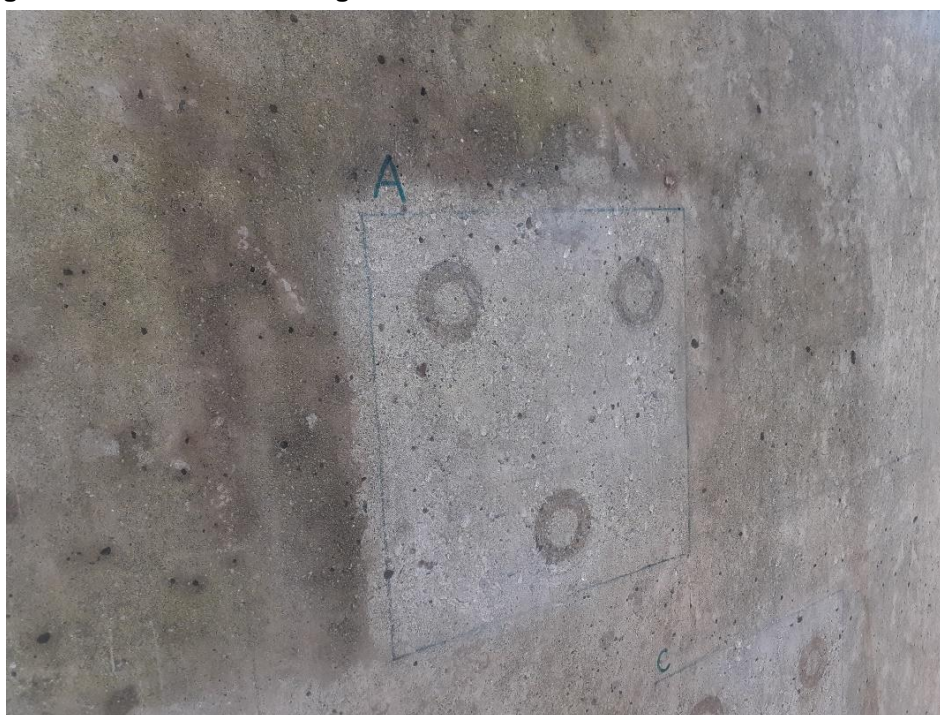
Figura 172 - Área do hidrofugante A: molhamento e escurecimento do entorno.
