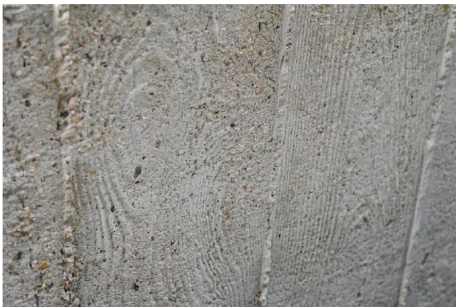
Figura 24 - Concreto marcado por fôrmas.
