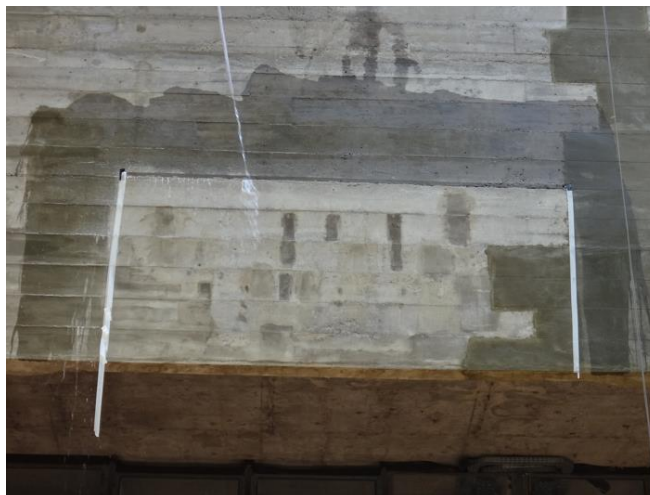
Figura 34 – Teste realizado na empena nordeste em área impregnada com hidrofugante à base de silano e siloxano indica que a superfície não é umedecida.
