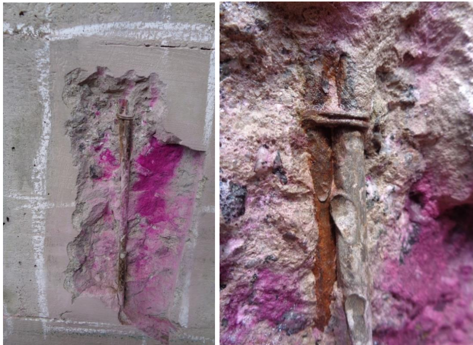
Figura 27 – Armadura corroída na empena nordeste. Imagem à esquerda mostra evidência de produto de corrosão (coloração alaranjada) sobre barra de aço, inclusive na interface com o concreto carbonatado. Imagem à direita é uma ampliação, evidenciando parte das barras envolvidas por argamassa de reparo que foi fraturada para inspeção da armadura. Parte da argamassa de reparo não está carbonatada (indicada pela área com alteração de cor após aspersão de solução de fenolftaleína).
