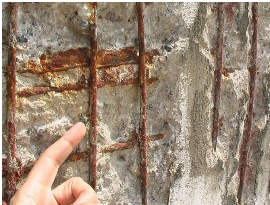
Figura 29 - Armaduras corroídas em uma viga de cobertura.
