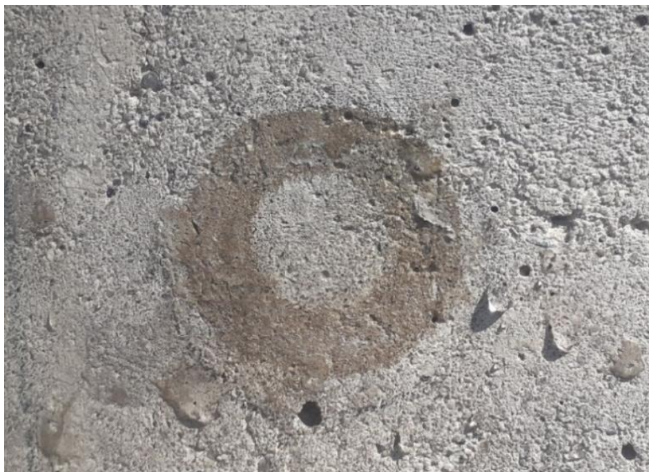
Figura 153 - Marca e restos deixados pela massa de calafetar logo após o ensaio com tubos de Karsten.
