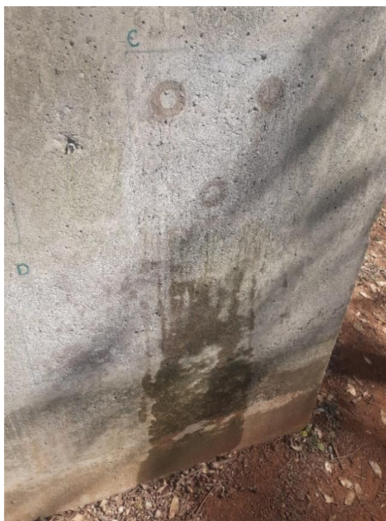
Figura 174 - Área do hidrofugante C: molhamento e escurecimento abaixo.
