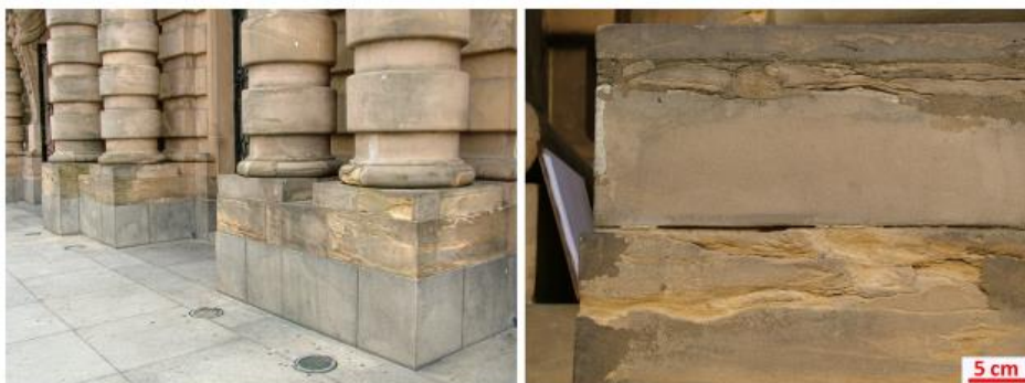
Figura 65 - Degradação do Arenito Itararé na fachada frontal do Theatro Municipal de São Paulo.
