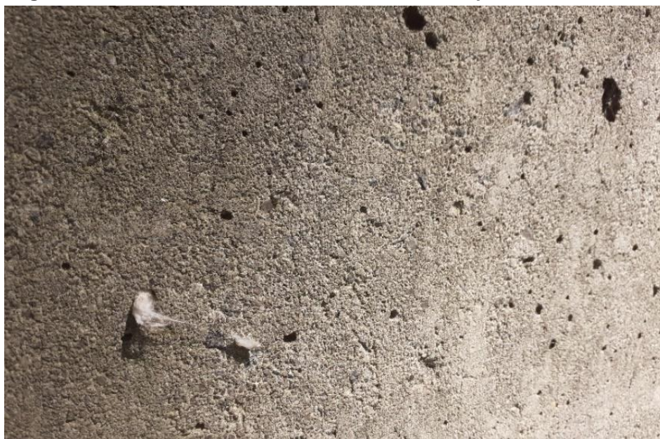
Figura 114 - Teia de aranha retirada de orifício na superfície do concreto.
