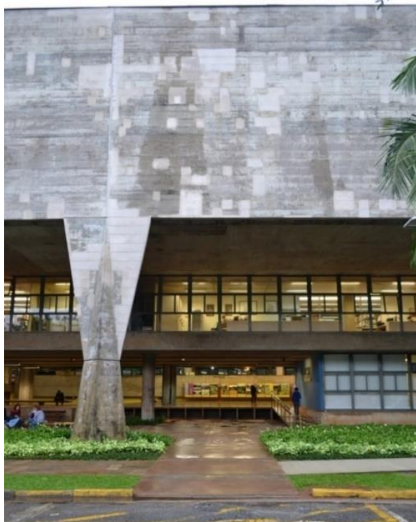
Figura 35 - Fachada sudoeste com mancha de umidade logo acima do canto superior direito do pilar. Imagem foi registrada no dia 19/05/2017, após precipitação de moderada intensidade, porém com 8 horas de duração.
