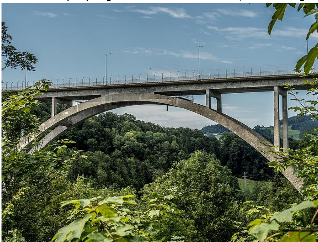
Figura 67 - Ponte Fürstenland, em St. Gallen, na Suíça, recebeu tratamento hidrofugante em forma de creme para proteger contra os efeitos da carbonatação e sais de degelo.
