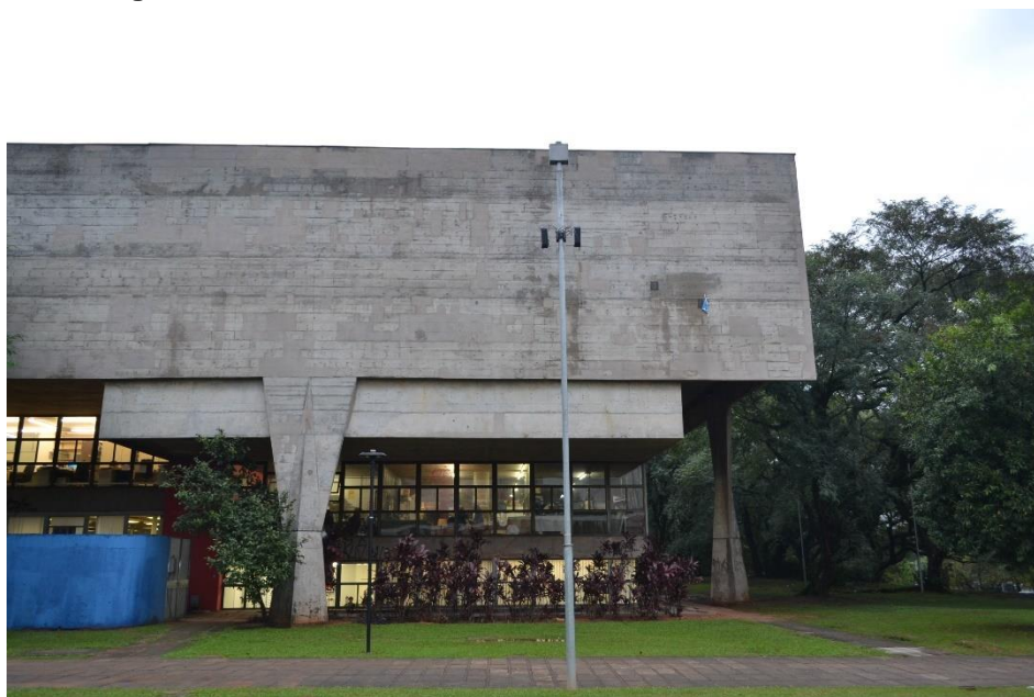
Figura 37 - Mancha de umidade à direita na fachada sudeste.
