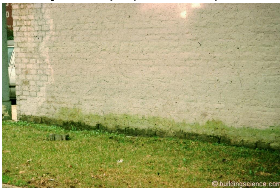
Figura 45 - Ascensão capilar na base de uma parede.
