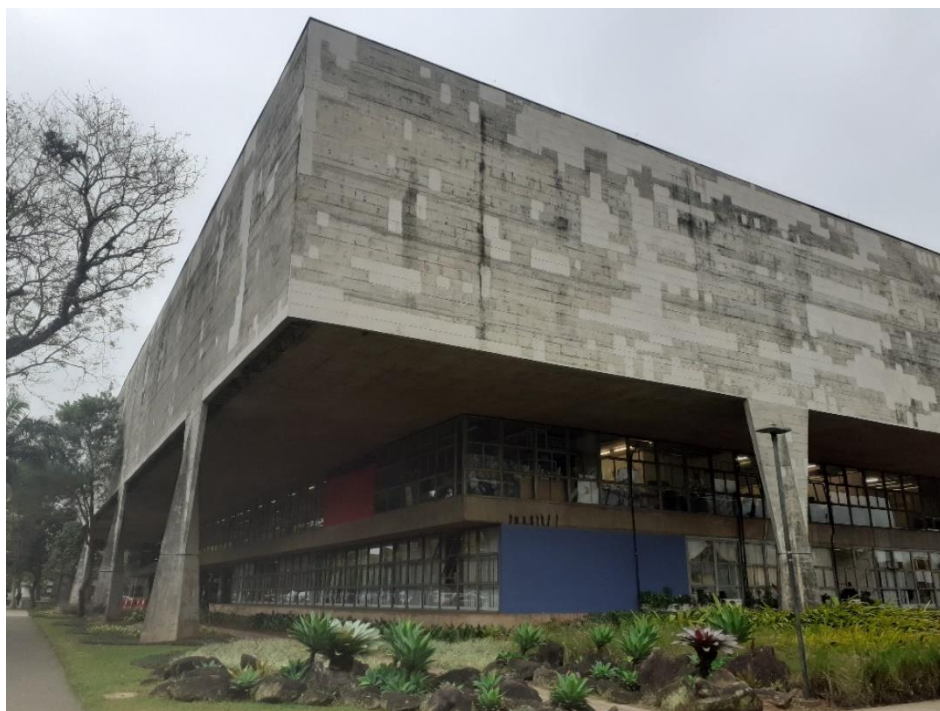
Figura 2 - Reparos com aspecto destoante da superfície original das empenas do edifício Vilanova Artigas nas fachadas sudoeste e sudeste.
