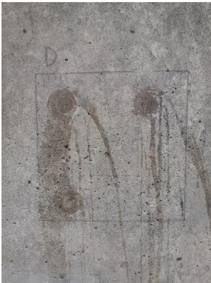
Figura 179 - Na área do hidrofugante D não houve formação de gotículas superficiais e não há diferença na aparência do molhamento da superfície hidrofugada e não hidrofugada.
