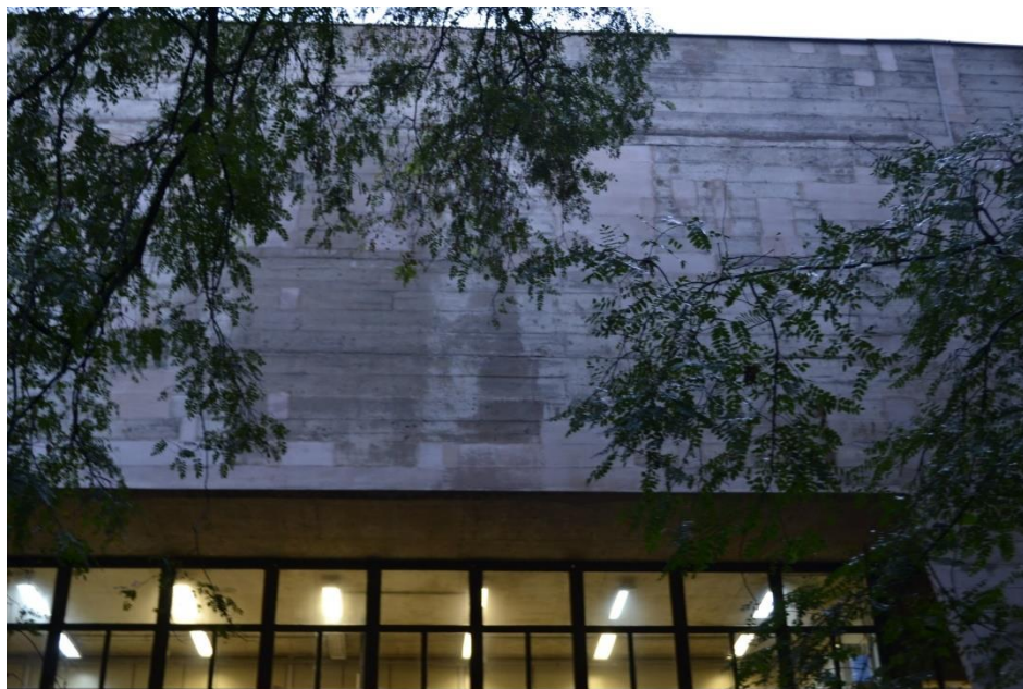
Figura 39 - Mancha de umidade próxima aos galhos de árvore na fachada nordeste.
