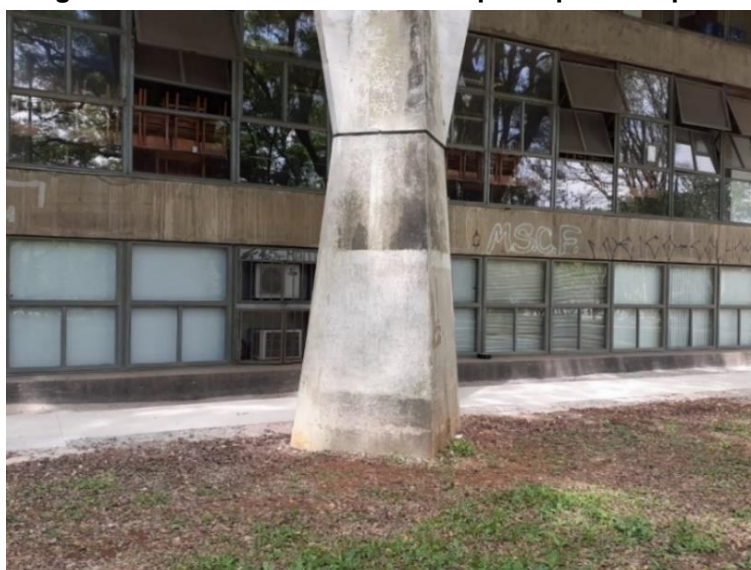
Figura 118 – Faixa da face leste do pilar após a limpeza.
