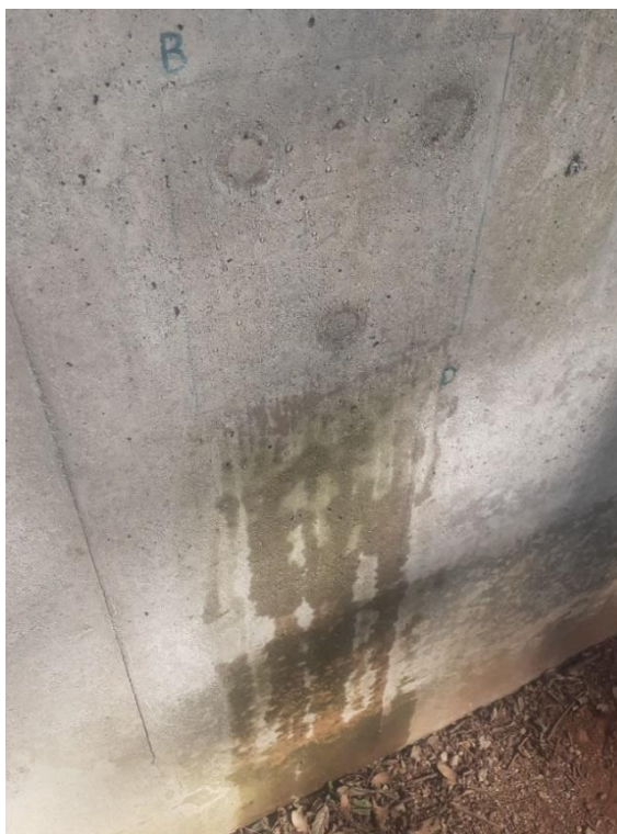
Figura 173 - Área do hidrofugante B: molhamento e escurecimento abaixo.
