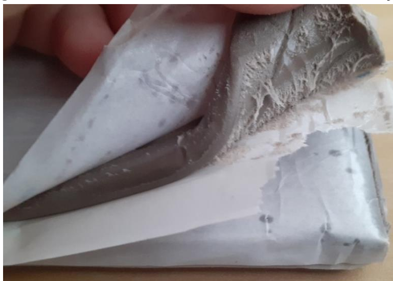
Figura 144 - Massa de calafetar mais aderente, de difícil remoção.
