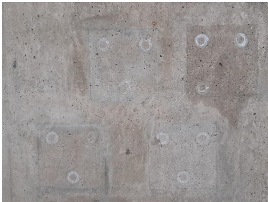
Figura 154 - Marcas da massa de calafetar esbranquiçadas, dias após o ensaio com tubos de Karsten.
