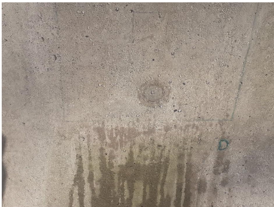
Figura 177 - Gotículas superficiais na área do hidrofugante B e logo abaixo molhamento da superfície.
