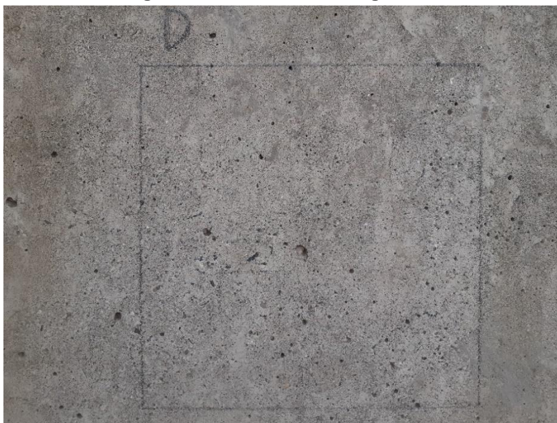
Figura 122 - Área do hidrofugante D.
