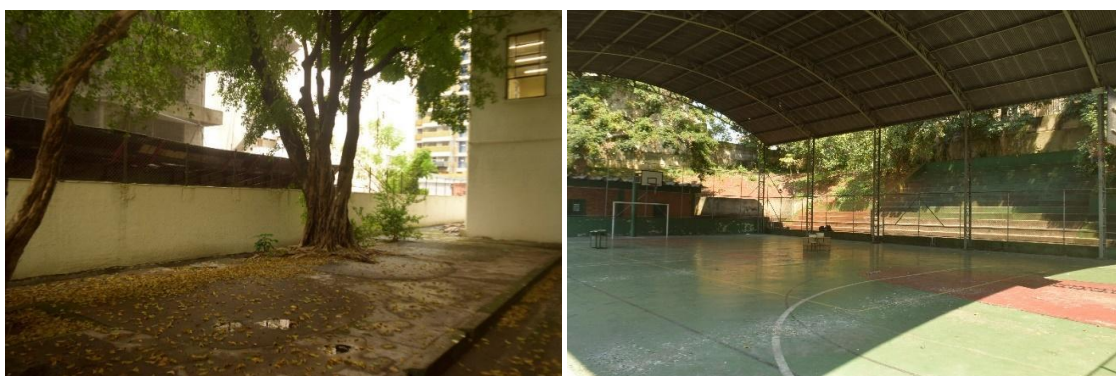
Figura 72: ECS A (esquerda) e B (direita) - Condições de muros laterais e propriedades adjacentes
