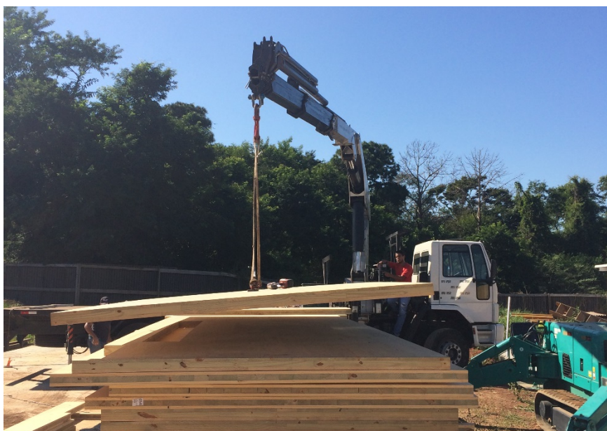
Figura 52: Içamento de painéis de MLCC localizados em uma pilha de estocagem em obra.
