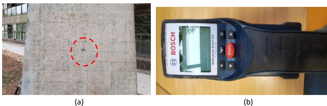
Figura 53: Imagens de (a) Localização e marcação das armaduras (b) detector de metais D-TECT 150 da Bosch usado para localizar as armaduras e espessura de cobrimento
