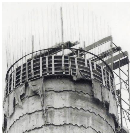
Figura 11: Detalhe das formas para moldagem do concreto do reservatório d'água do Sesc Pompeia, sistema desenvolvido pela Lina Bo Bardi para homenagear o arquiteto mexicano Luís Barragán e remeter a memória das rendeiras cajazeiras.
