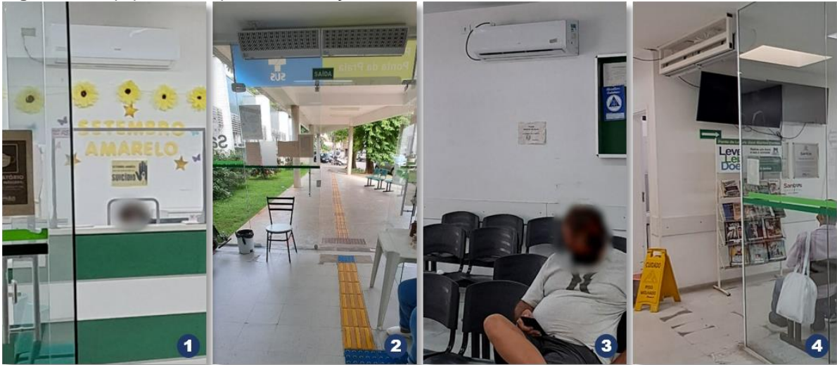
Figura 74. Equipamentos para climatização do ar na UBS Ponta da Praia.
