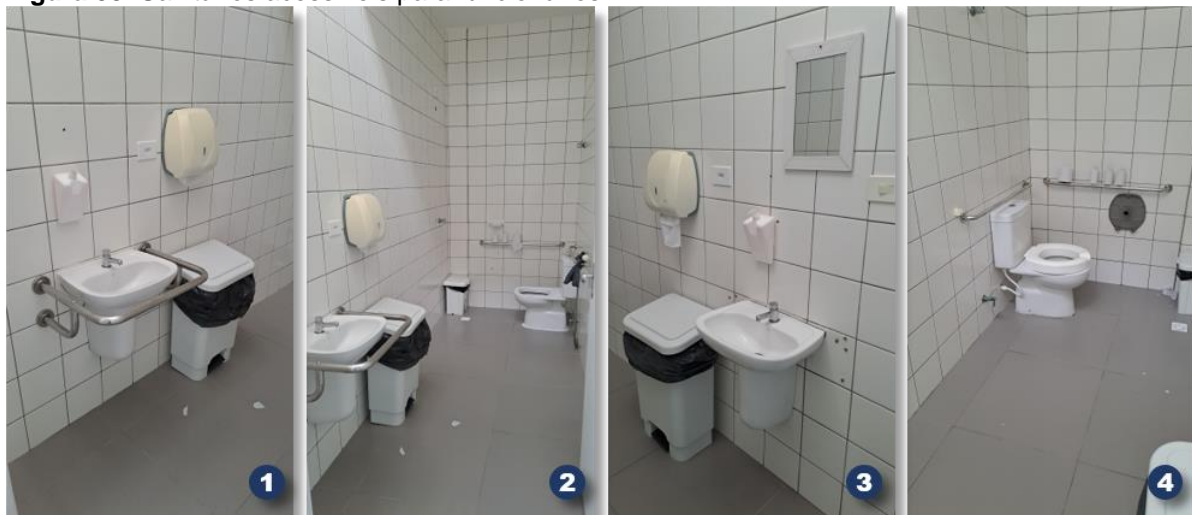
Figura 59. Sanitários acessíveis para funcionários.
