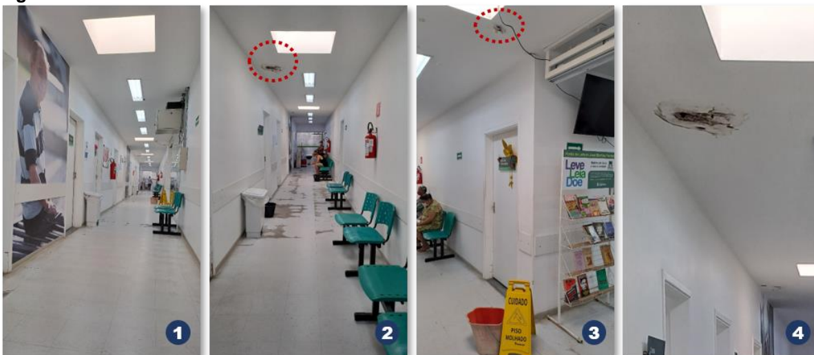
1 e 2) claraboias posicionadas no corredor de atendimento clínico; 3 e 4) Pontos de infiltração e gotejamento de água da chuva. Fonte: Acervo do pesquisador, 2022.
