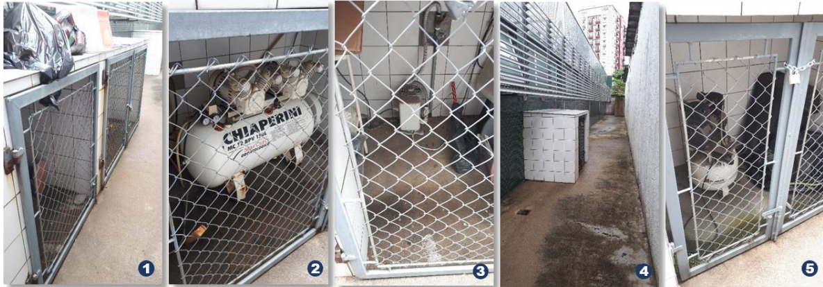
Figura 81. Equipamentos instalados nos fundos da UBS Ponta da Praia.
