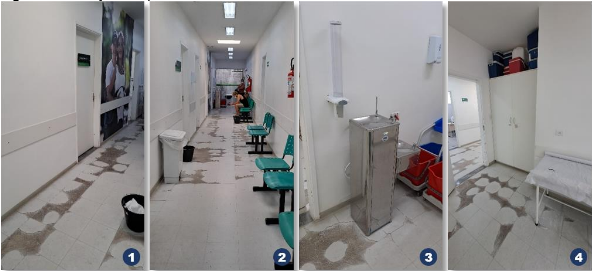
1, 2 e 3) Estado de conservação dos pisos no corredor de acesso às salas de atendimento clínico; 4) Piso na sala de observação. Fonte: Acervo do pesquisador, 2022.
