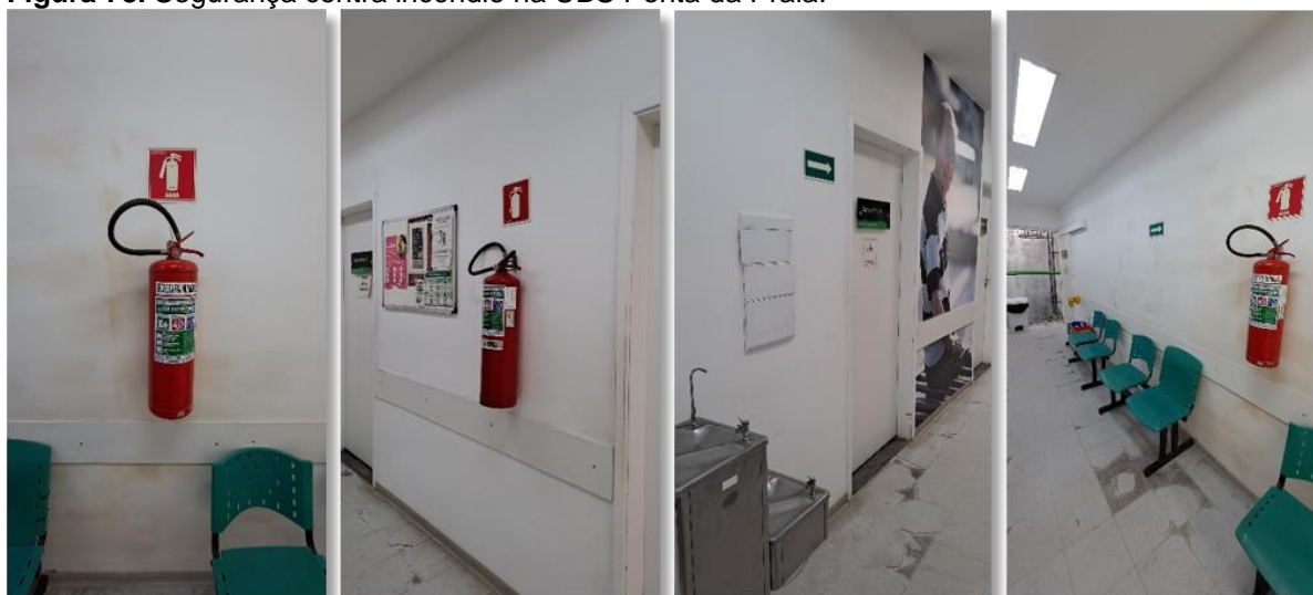
Figura 78. Segurança contra incêndio na UBS Ponta da Praia.
