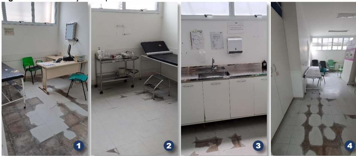
Figura 54. Conservação dos pisos vinílicos na UBS Ponta da Praia.
