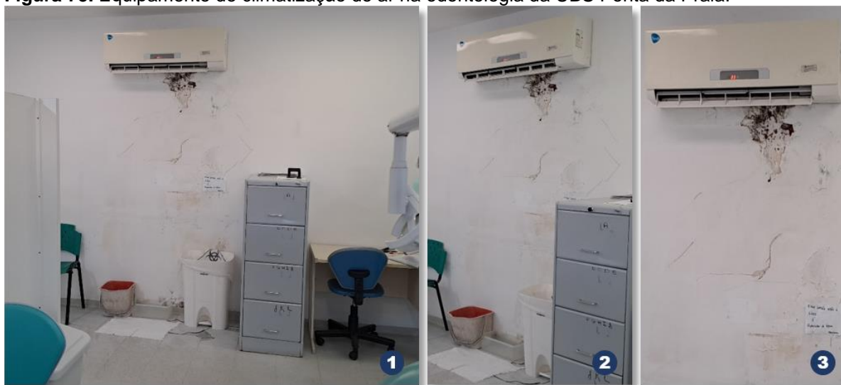
Figura 75. Equipamento de climatização do ar na odontologia da UBS Ponta da Praia.
