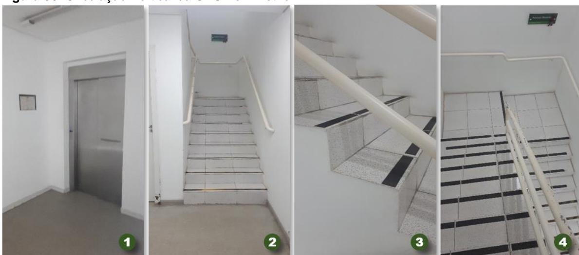
1) Elevador inoperante; 2, 3 e 4) Escada de acesso aos ambientes administrativos fora do padrão normativo de acessibilidade. Fonte: Acervo do pesquisador, 2022.
