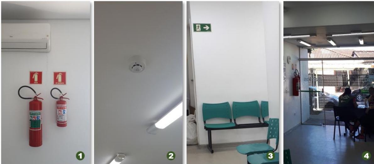
Figura 48. Segurança contra incêndio na UBS Bom Retiro.
