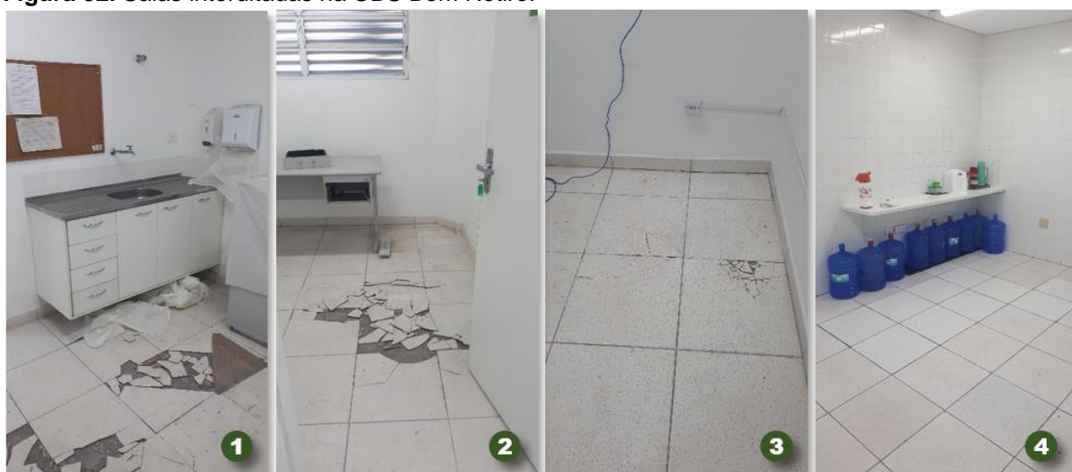
Figura 32. Salas interditadas na UBS Bom Retiro.
