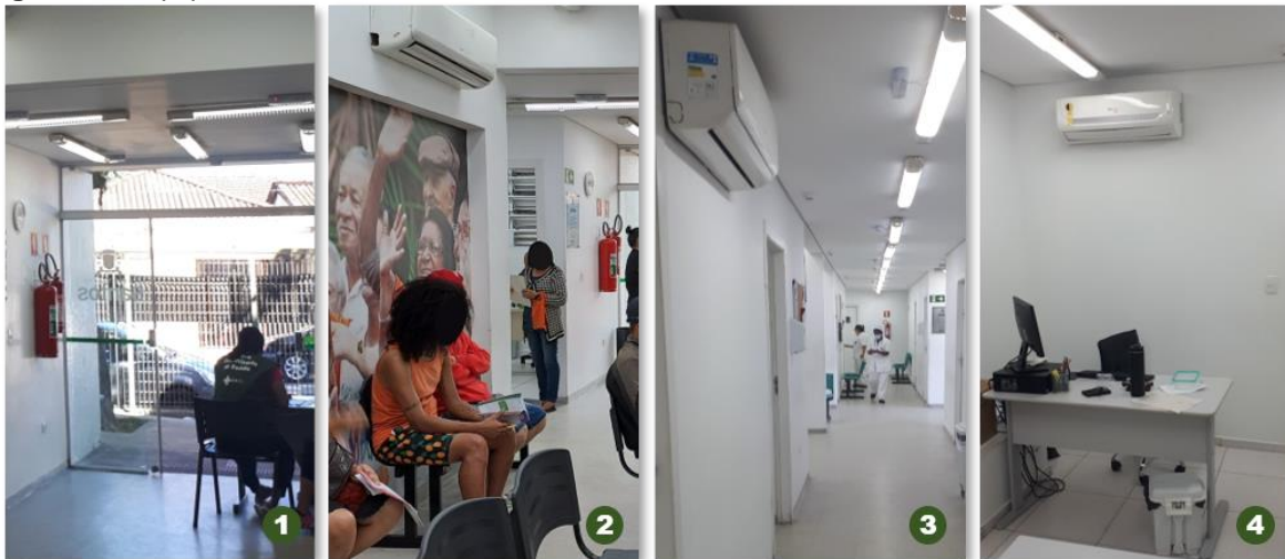
Figura 46. Equipamentos de ar condicionado da UBS Bom Retiro.
