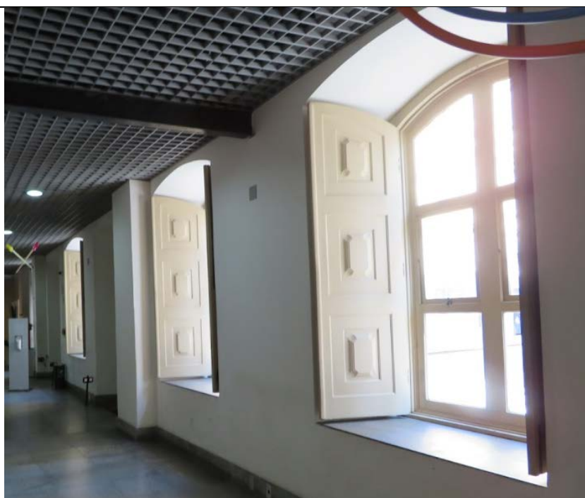
Figura 5.2 – Fotografia da Parede do saguão.
