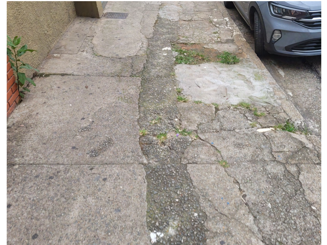
9.7. Calçada sem manutenção adequada, irregular e com baixa qualidade de piso, localizada na Rua Piauí (trecho 9). Fonte: autoria própria.
