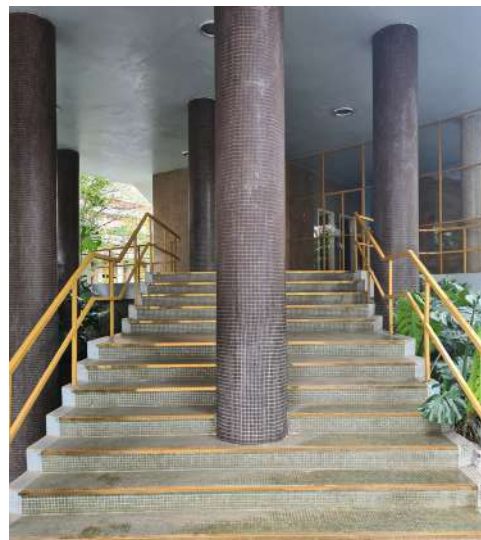
2 Degraus no térreo revestidos com pastilhas. Identificado na tabela como "2". Fonte: Autora, 2020.
