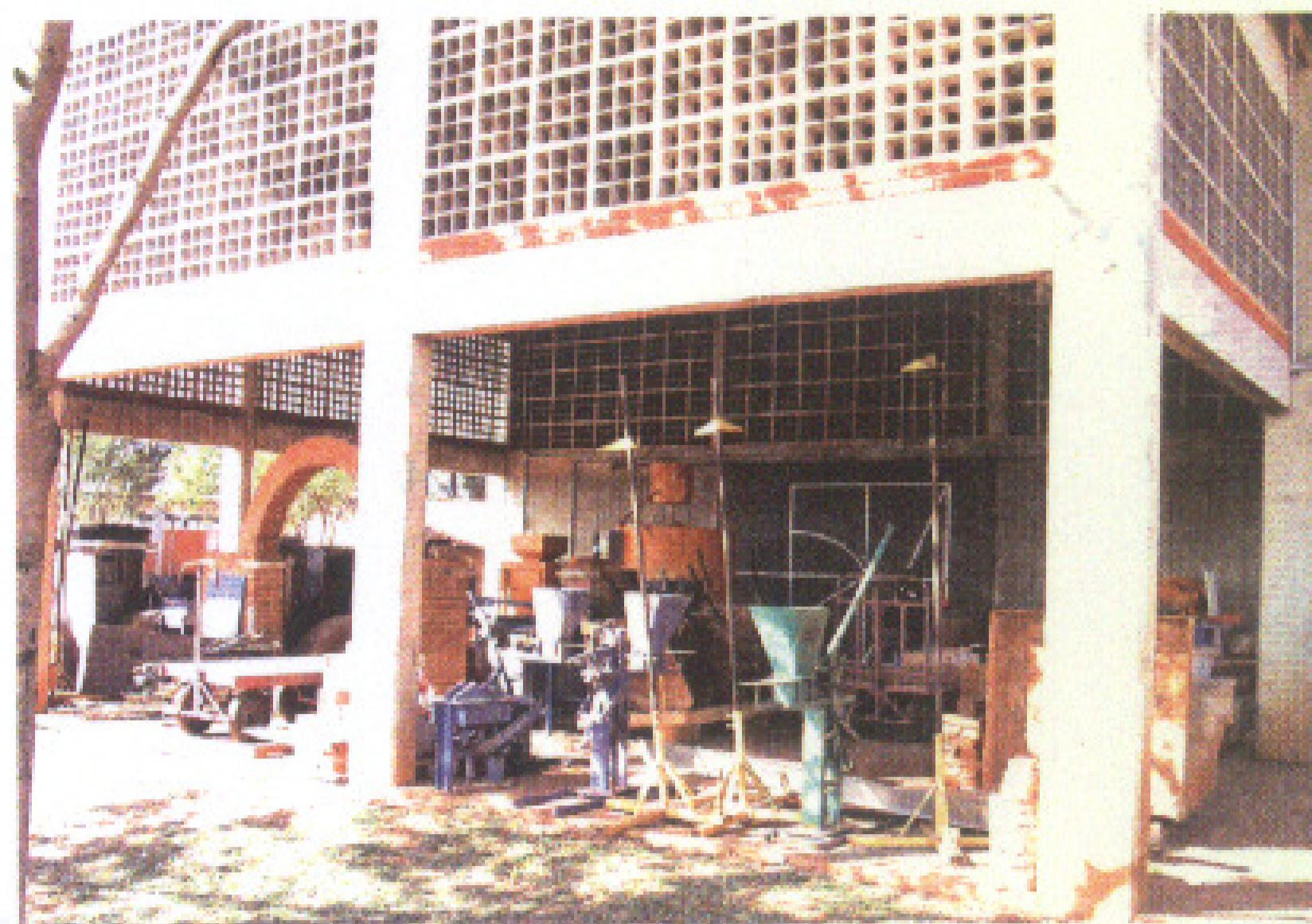
Figura 5: Aspecto da área aberta e coberta do Canteiro. (foto Nuno de A. Fonseca)
