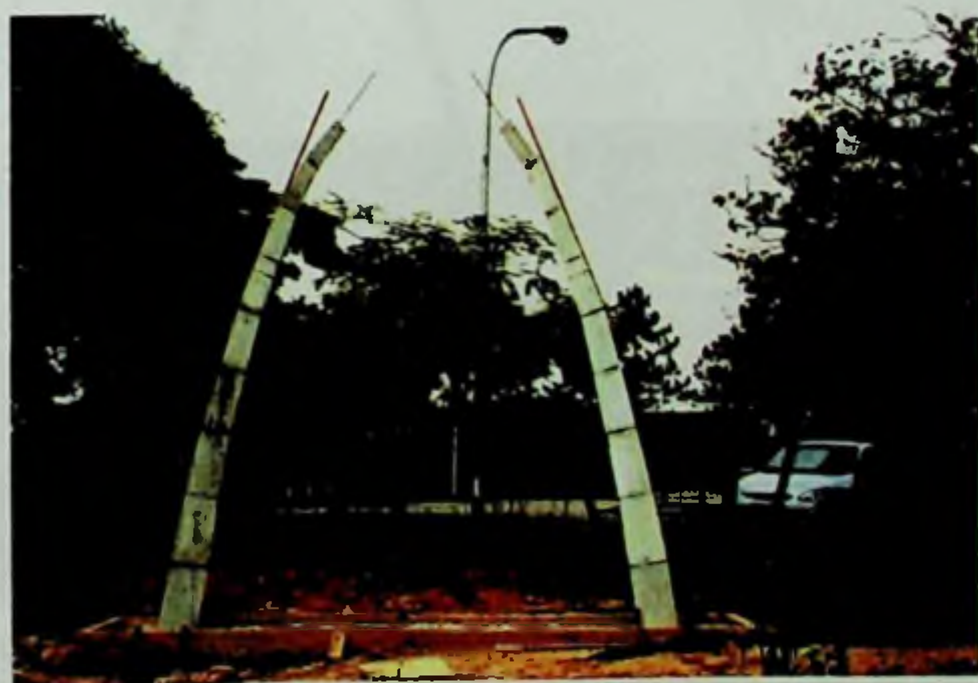
Figura 157: O arco quase pronto. Veja as madeiras (ripas) que auxiliam o posicionamento das peças.
