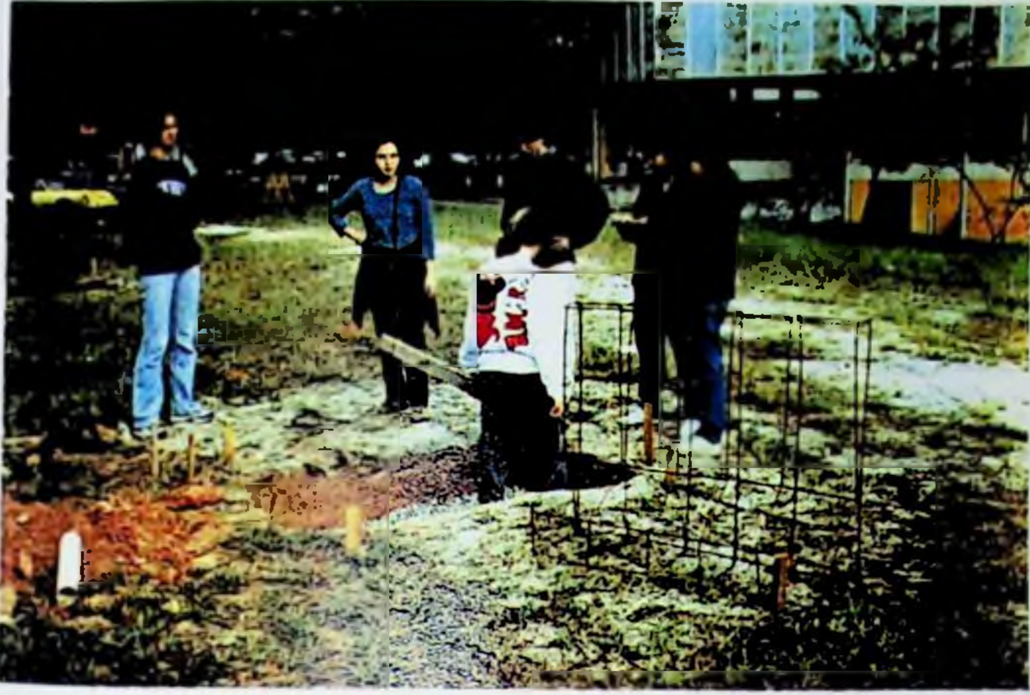
Figura 172: Pronta a escavação, os estudantes irão posicionar a armadura e iniciar a concretagem.
