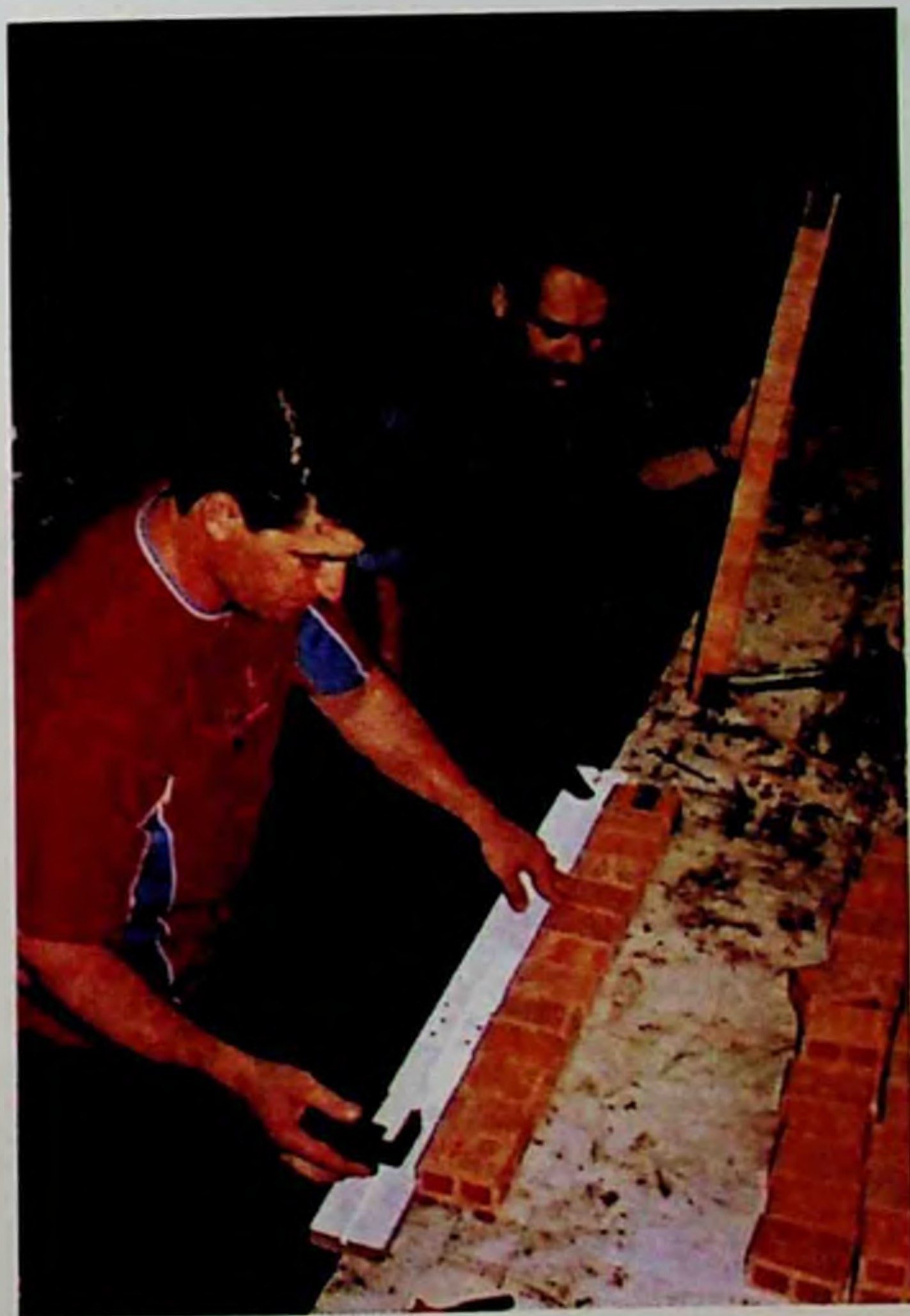
Figura 55: Encaixe do dispositivo metálico. Note no plano do fundo uma das barras já estabilizada.
