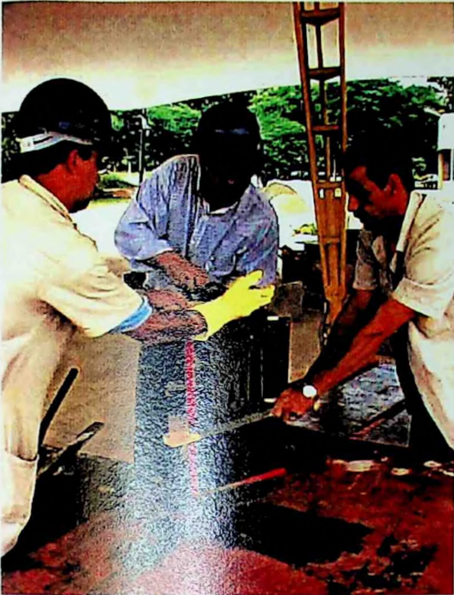
Figura 142: O trabalho de argamassagem foi bastante dificultado devido a utilização de poucos travamentos nas formas.
