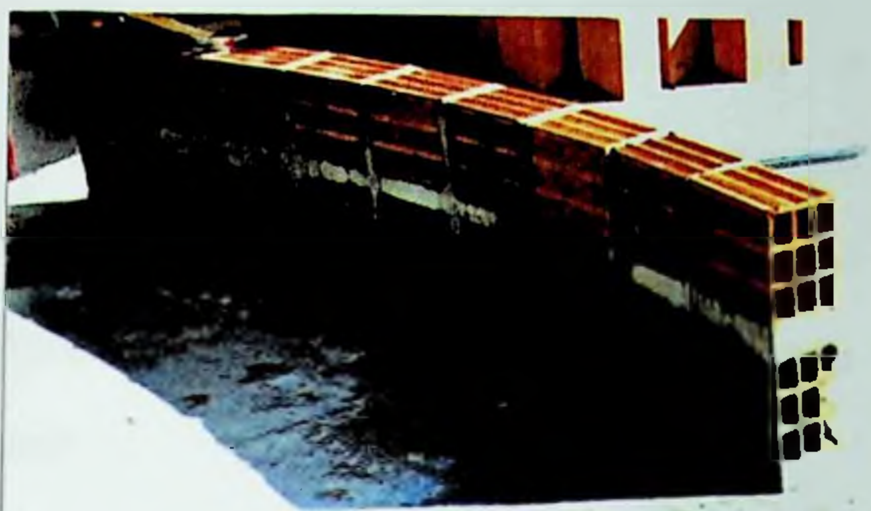
Figura 182: Mesmo com todos os cuidados alguns painéis ainda apresentaram falhas na argamassagem das juntas.
