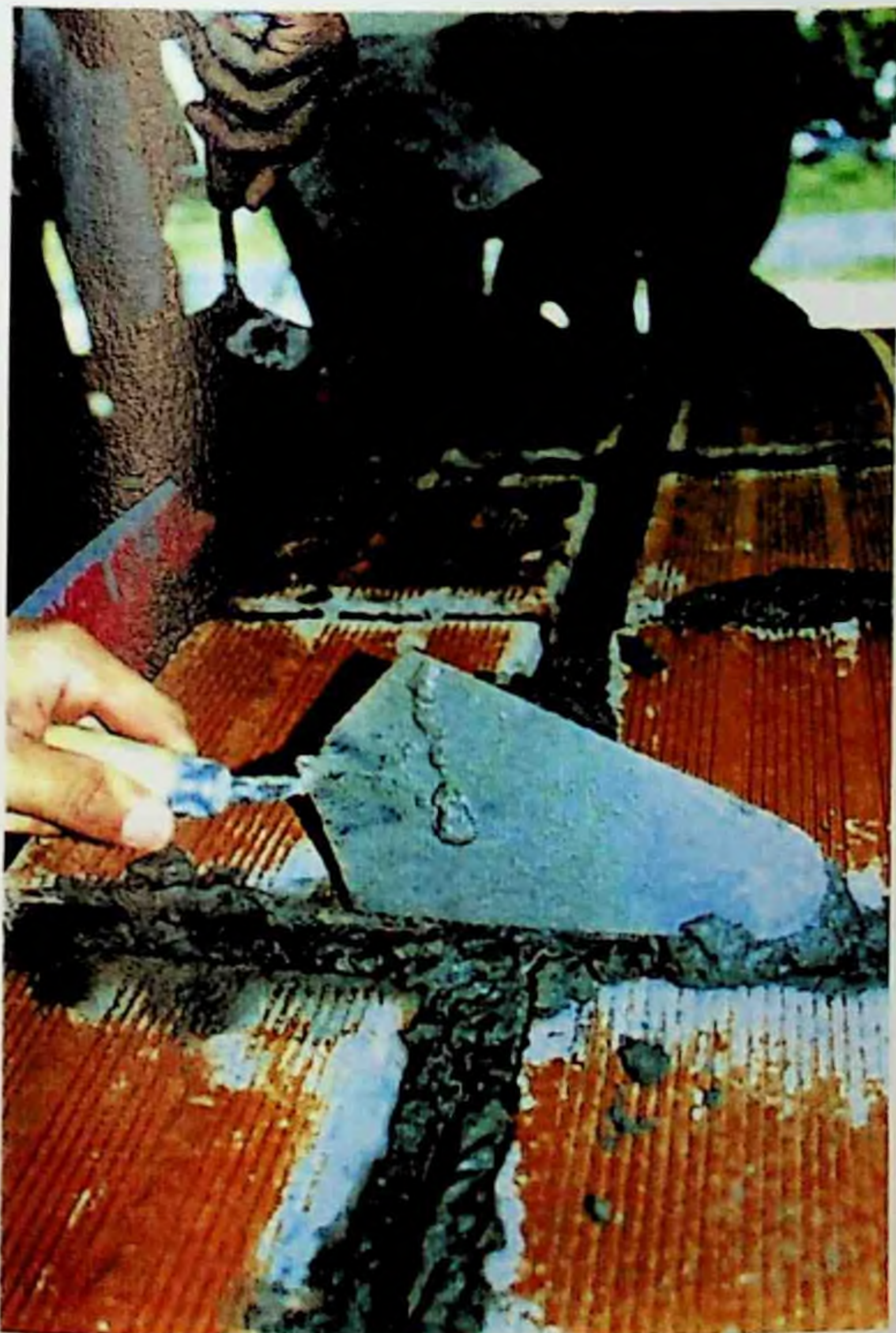
Figura 180: É importante garantir a presença da argamassa em toda a profundidade das juntas.
