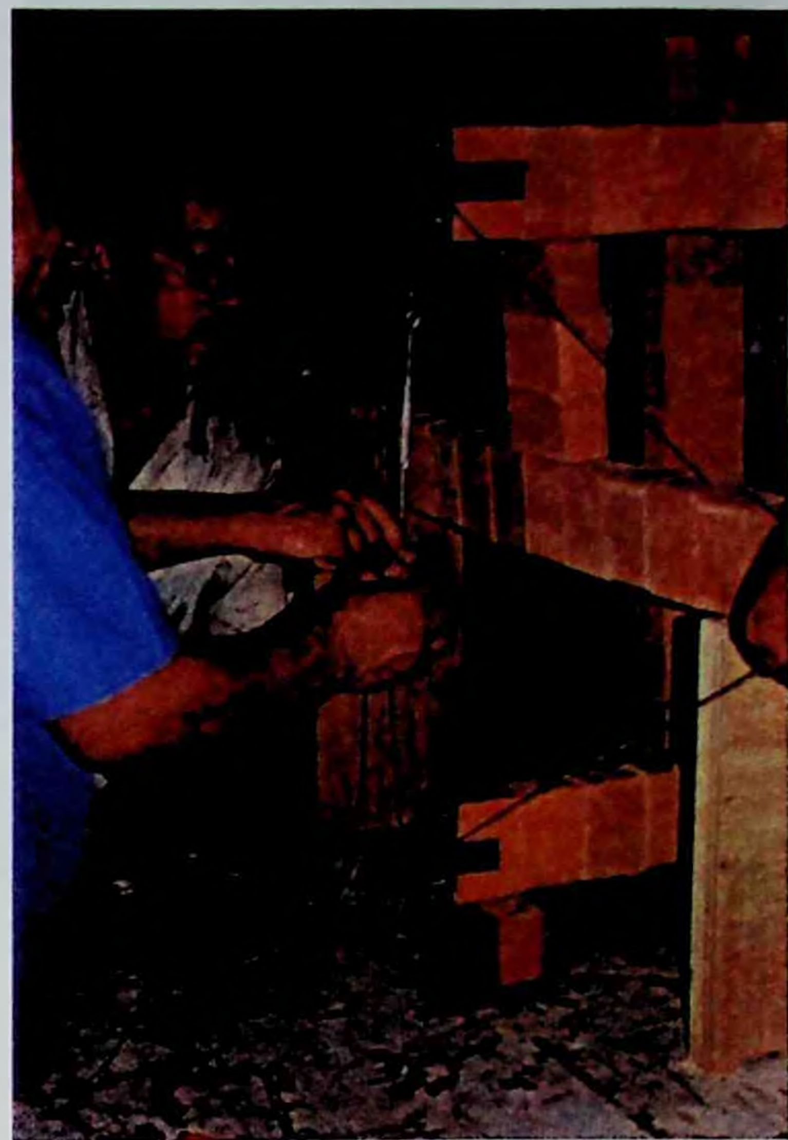
Figura 56: Embora tivéssemos calculado os comprimentos dos cabos, alguns ajustes tiveram que ser feitos durante a montagem,
