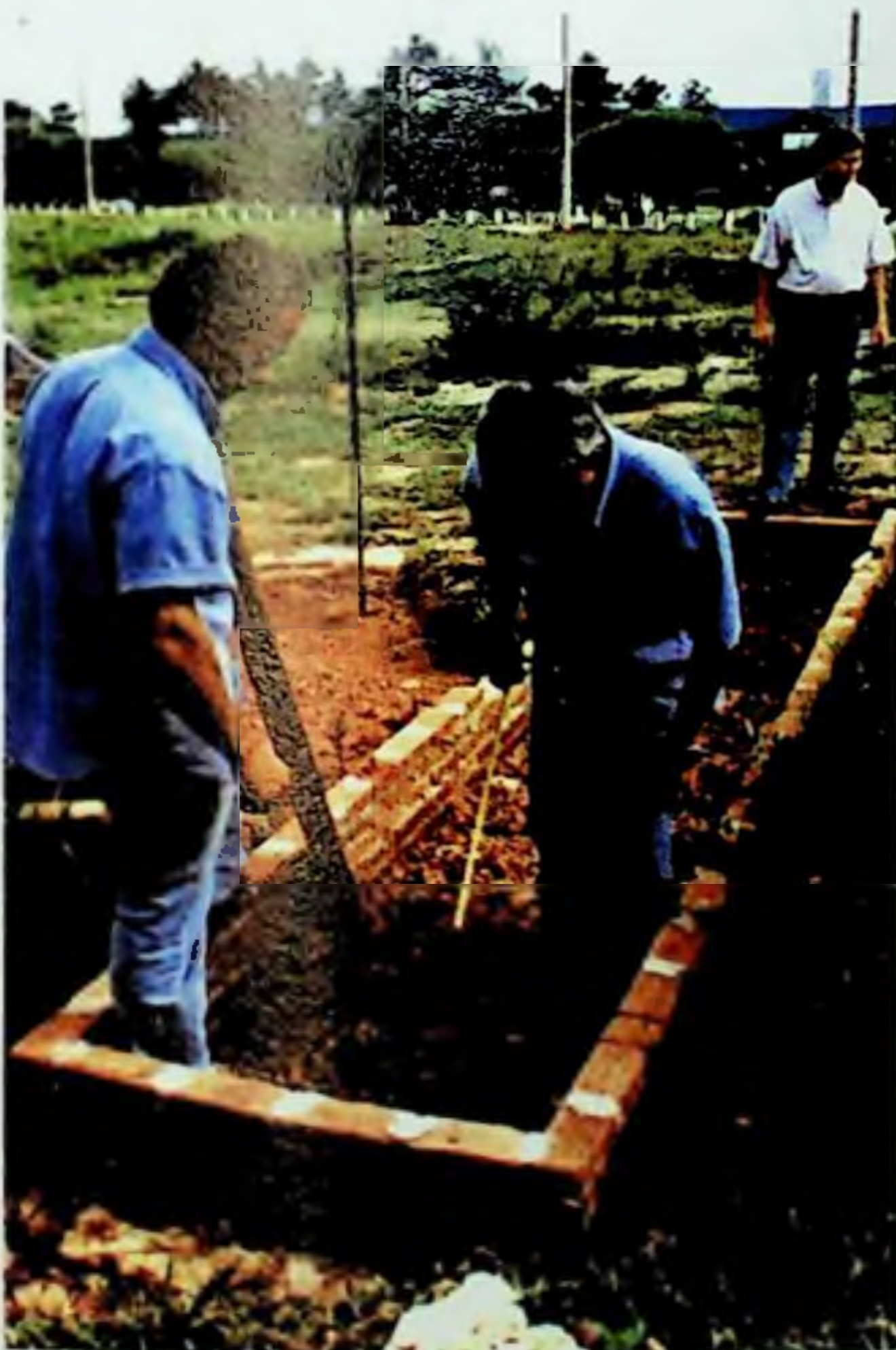
Figura 144: Início do trabalho das fundações. O auxílio dos técnicos do LAME, foi fundamental.
