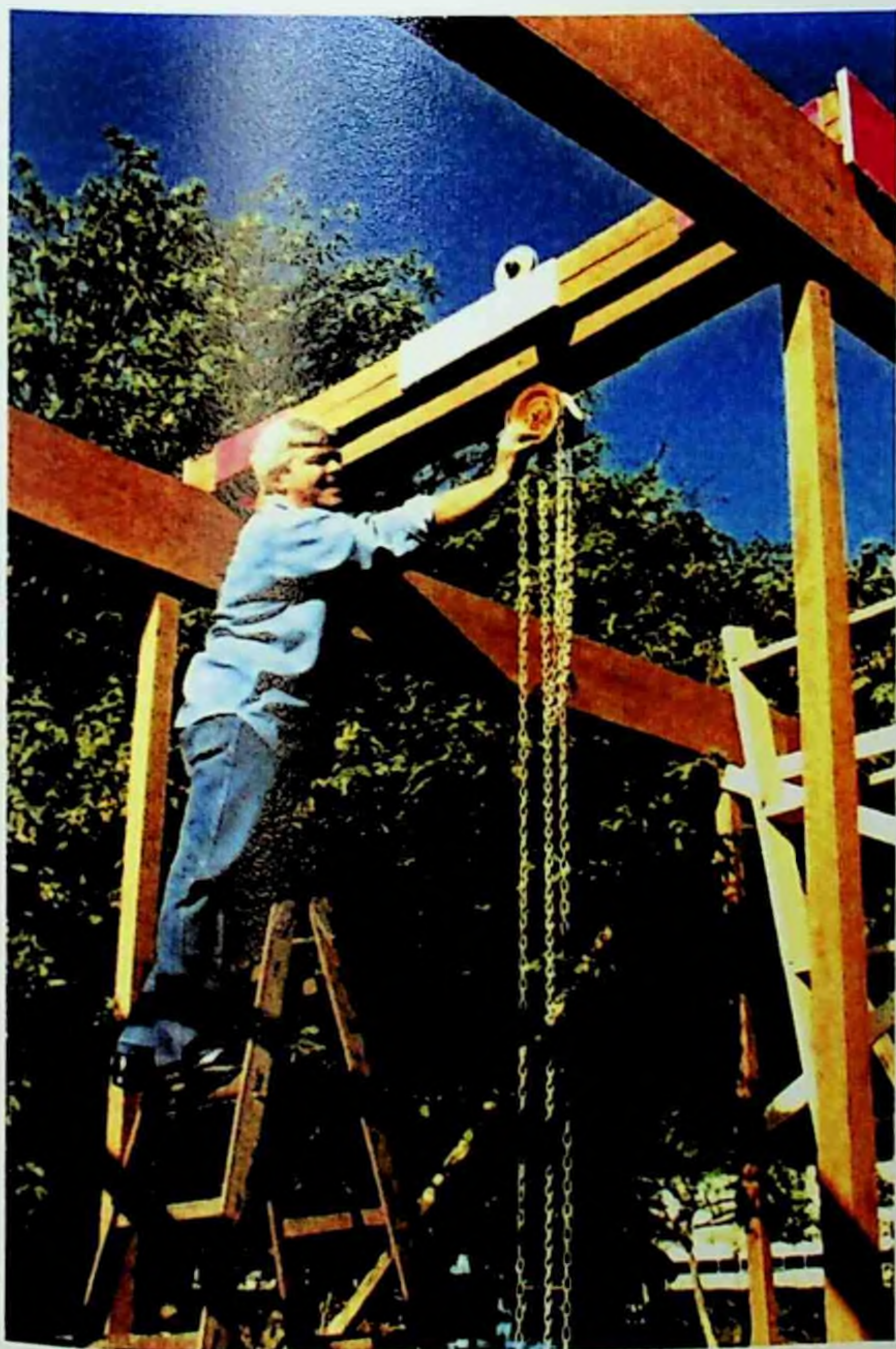
Figura 187: A "ponte rolante" construída nas oficinas e em pleno uso.
