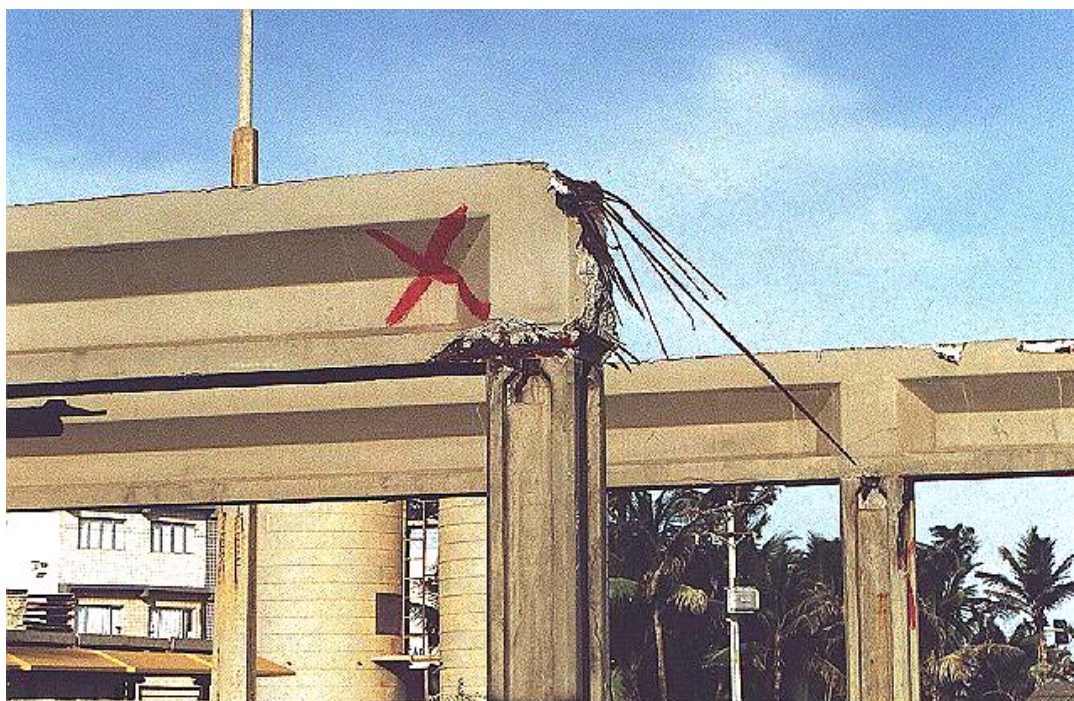
Figura 6.2 – Detalhe da estrutura comprometida do IME Prof. José Arapiraca (Salvador-BA)
