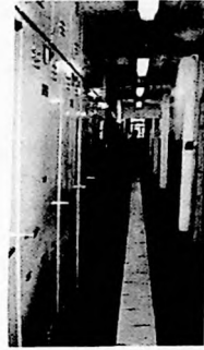
portaria 1 e entrada de energia
