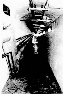
acesso à Pça Ramos - duto de ar condicionado
