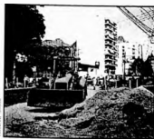
Obra do Rio Cidade, no Grajaú As obras simultâneas causam grandes transtornos mas aumentam as expectativas quanto aos resultados.
