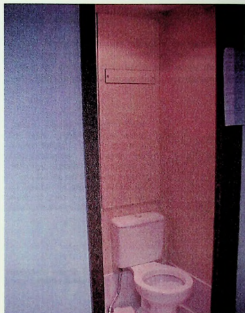
Figura 3.14 - Sanitário com Manifold e Sistema Pex Fonte: obra Corporate Plaza – construtora Inpar
