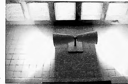
Figura 193 - Luminária dos banheiros
