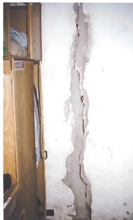
Foto 47 – Habitação 11: rachadura em parede executada pelo morador (vista interna).
