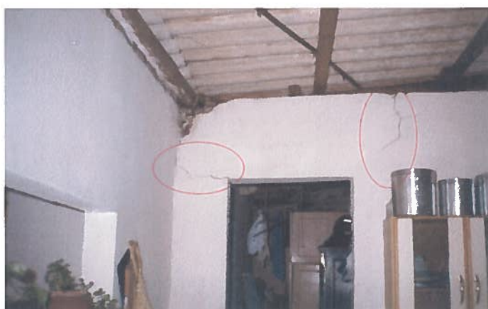
Foto 100 – Habitação 24: paredes divisórias executadas pelo morador, apresentando trincas.
