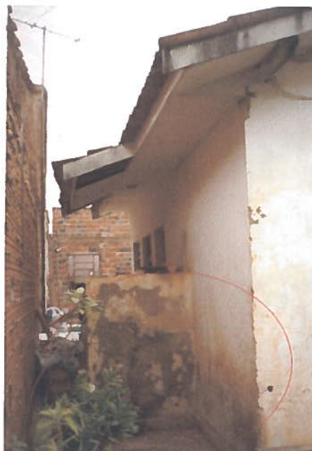
Foto 108 – Habitação 26: marcas de infiltrações nas paredes.
