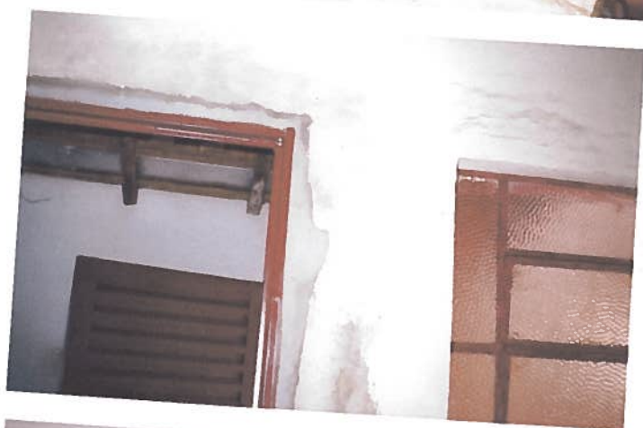
Foto 81 – habitação 20: marcas de substituição da esquadria (porta).
