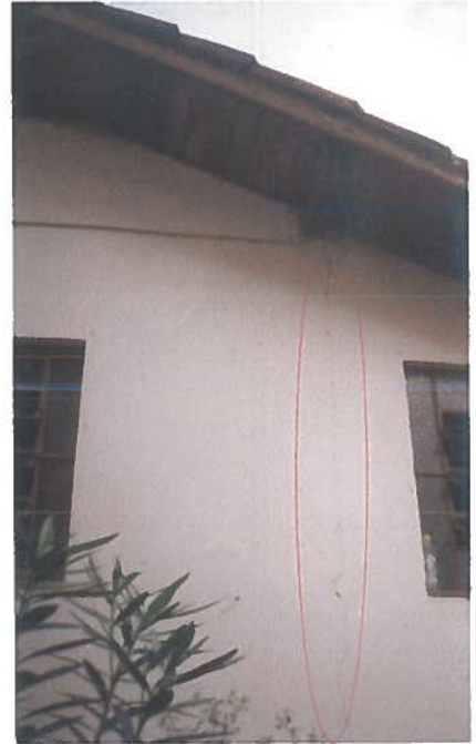
Foto 138 –Habitação pré-teste 03: Parede frontal com trincas na região de emenda, entre a parede original e a ampliada.
