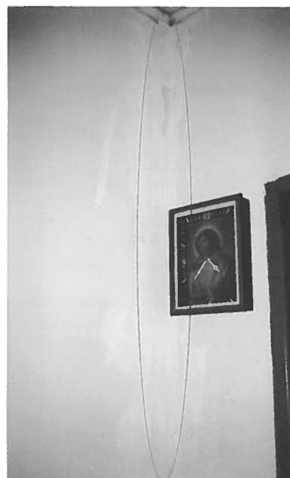
Foto 12 – Habitação 03: trinca na emenda entre a parede original e a parede executada pelo morador.
