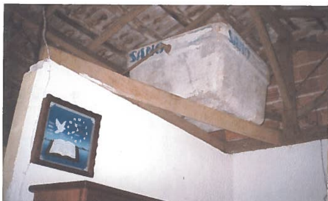
Foto 106 – Habitação 26: apoio da caixa d'água, executado sem observar as técnicas usuais da construção civil.
