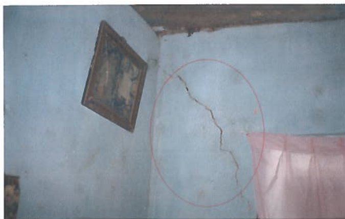
Foto 128 – Habitação pré-teste 01: rachadura em paredes.
