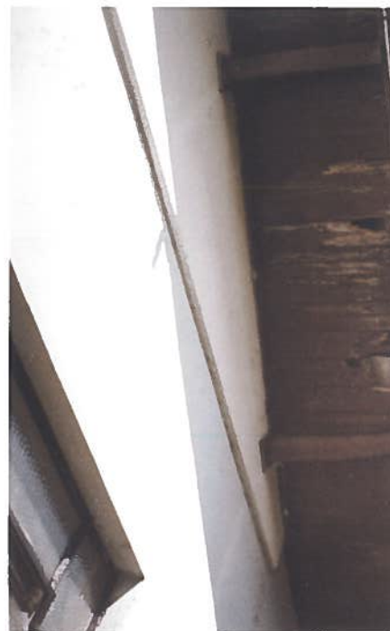
Foto 55 – Habitação 13: forros dos beirais, deteriorados.
