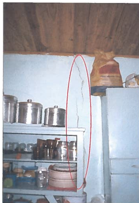
Foto 125 – Habitação 30: trinca vertical em parede executada pelo morador.
