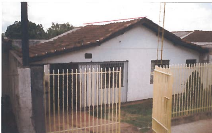
Foto 21 – Habitação 06: elevação frontal e cobertura (em péssimo estado).
