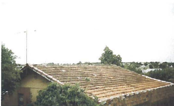
Foto 35 – Habitação 09: cobertura selada e com ondulações.
