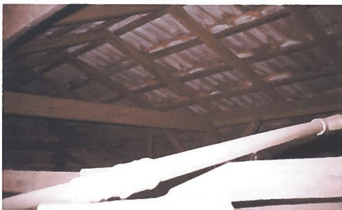
Foto 27 – Habitação 07: execução das instalações hidráulicas sem utilizar as técnicas usuais da construção civil.
