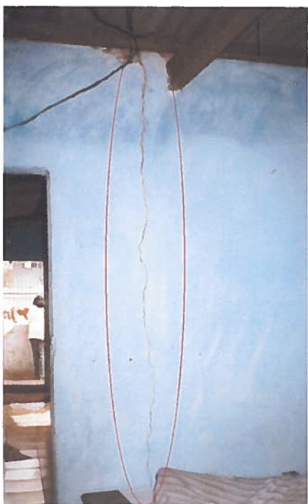
Foto 31 – Habitação 08: rachadura vertical em parede divisória executada pelo morador.
