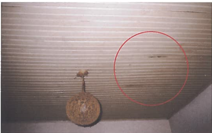
Foto 50 – Habitação 12: forro com marcas de infiltrações oriundas de vazamentos do telhado.
