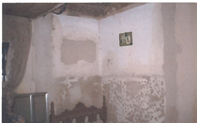
Foto 113 – Habitação 28: ampliações e alterações executadas pelo morador.
