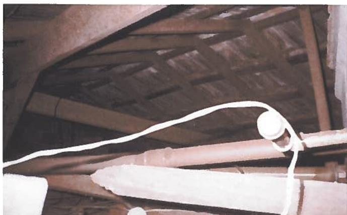
Foto 22 – Habitação 06: instalações elétricas e hidráulicas executadas sem as técnicas usuais da construção civil.
