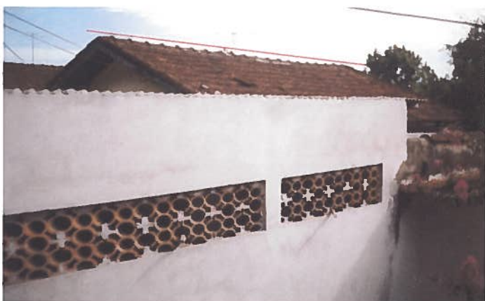
Foto 49 – Habitação 12: cobertura selada e com telhas soltas.
