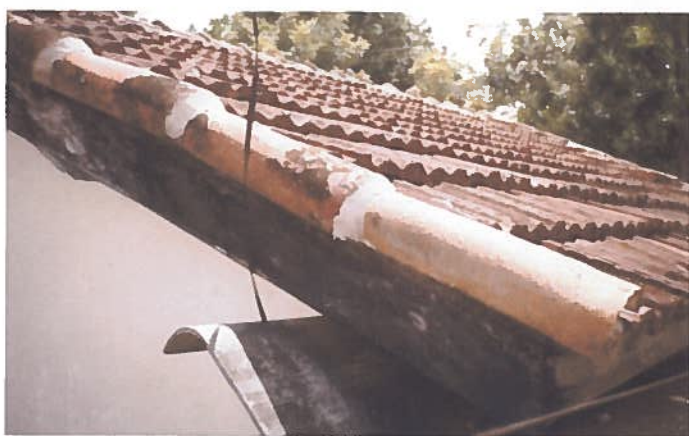
Foto 18 – Habitação 05: vistas e forros dos beirais sem pintura (péssimo estado de conservação).
