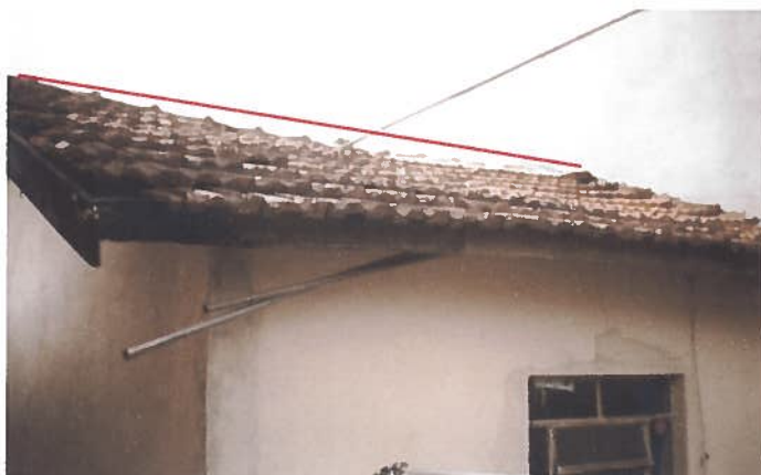
Foto 69 – Habitação 17: telhado ondulado, selado e, com beirais em péssimo estado de conservação (na área ampliada pelo morador).
