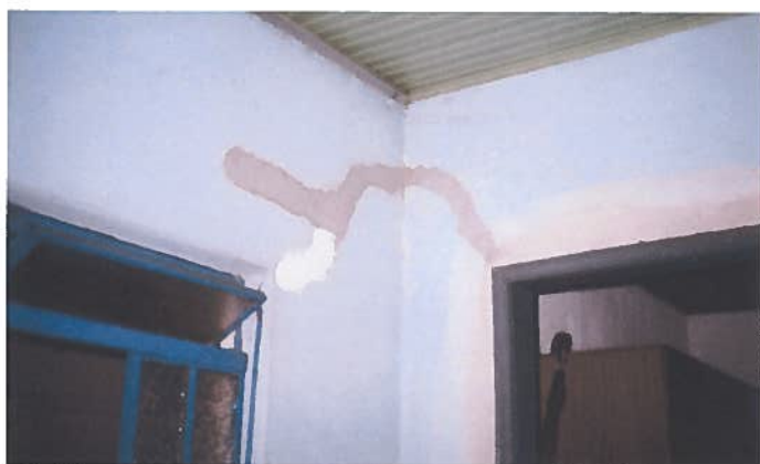
Foto 26 – Habitação 07: reparos executados pelo morador em função das trincas.
