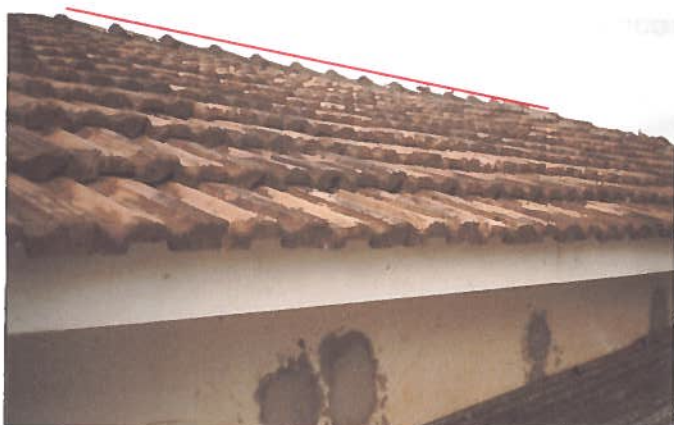
Foto 122 – Habitação 30: cobertura com ondulações.
