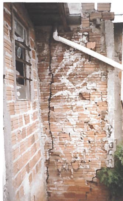
Foto 46 – Habitação 11: rachadura em parede executada pelo morador (vista externa).
