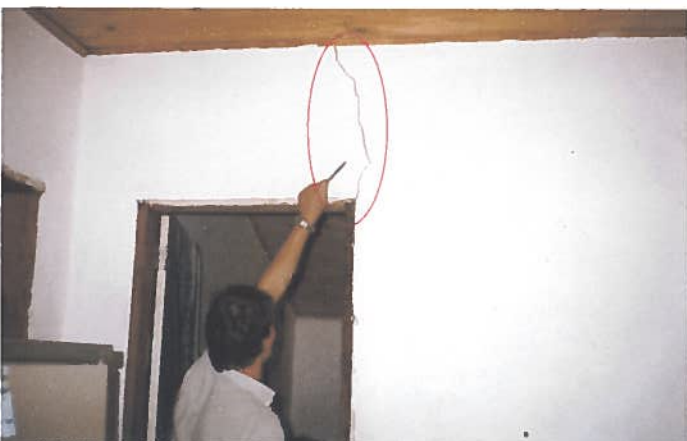
Foto 79 – Habitação 19: fissuração típica nos cantos das aberturas, em função da ausência de contra-verga.
