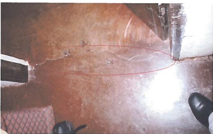
Foto 60 – Habitação 15: trincas em piso cimentado.
