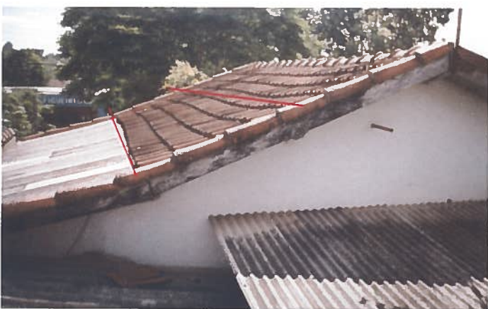
Foto 53 – Habitação 13: cobertura selada e beirais em péssimo estado de conservação.
