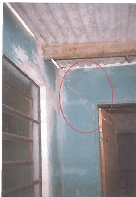
Foto 124 – Habitação 30: trinca sobre a porta (ausência de contra-verga) – área ampliada pelo morador.
