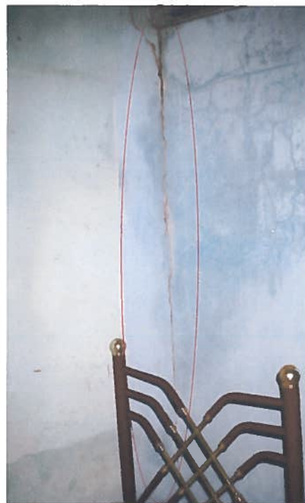
Foto 32 – Habitação 08: rachadura na junção entre a parede original e a parede executada pelo morador.
