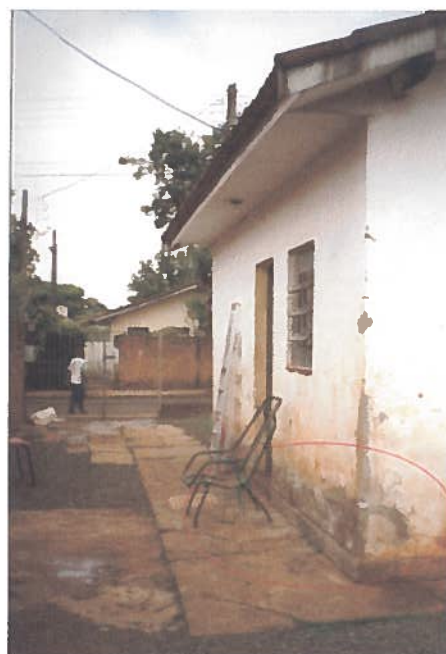
Foto 109 – Habitação 26: marcas de infiltrações na base das paredes.
