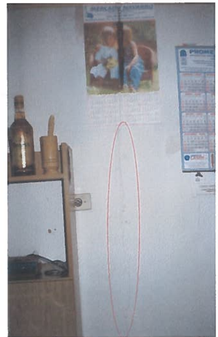
Foto 139 –Habitação pré-teste 03: Parede em área ampliada, com trinca vertical.
