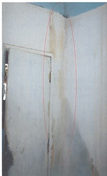
Foto 120 – Habitação 29: trincas e marcas de infiltrações na região de emenda (entre a parede original e a parede executada pelo morador – oitão frontal).
