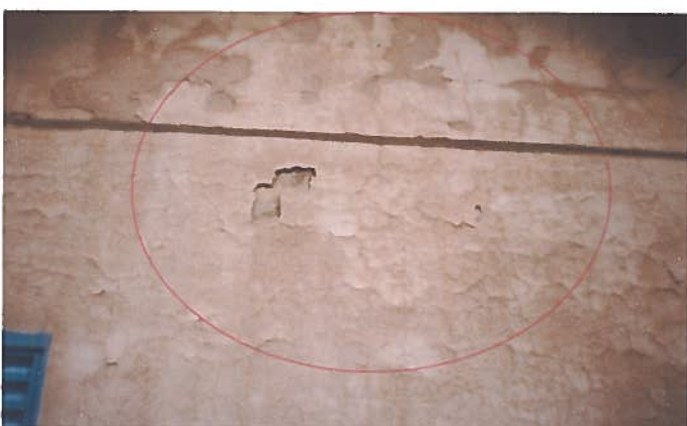
Foto 89 – Habitação 22: elevação frontal (destacamento e formação de bolhas na pintura).
