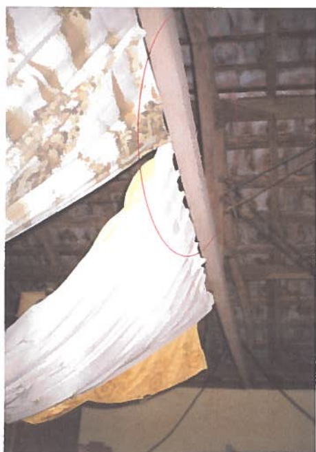
Foto 107 – Habitação 26: estrutura do telhado com peças empenadas e seladas.
