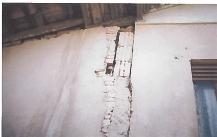
Foto 66 – Habitação 16: emenda entre a parte original e a parte ampliada, sem observar as técnicas usuais de construção civil.
