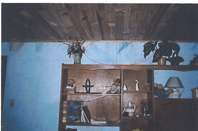
Foto 40 – Habitação 10: marcas de infiltrações oriundas do telhado original (substituído pelo morador).
