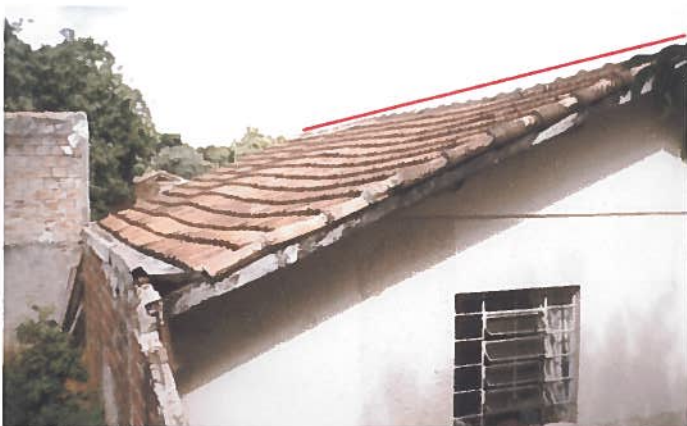
Foto 77 – Habitação 19: telhado em péssimo estado (ondulado e selado), com muitas goteiras.
