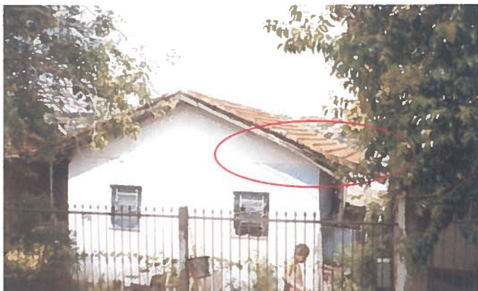
Foto 97 – Habitação 24: elevação frontal (beirais soltando).
