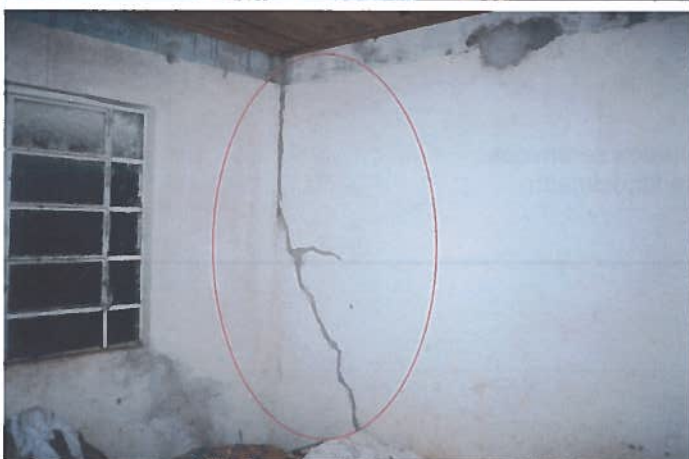
Foto 41 – Habitação 10: rachaduras em paredes executadas pelo morador (reparos realizados pelo morador).
