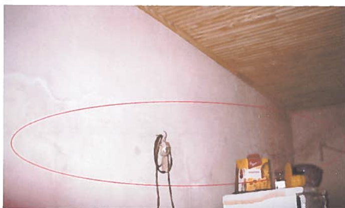
Foto 19 – Habitação 05: ampliação executada pelo morador (parede com trincas em toda sua extensão).
