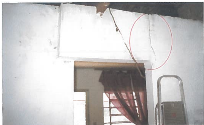
Foto 131 – Habitação pré-teste 02: Parede interna executada pelo morador, apresentando rachadura.
