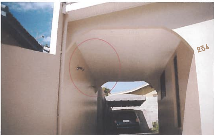
Foto 58 – Habitação 14: vista interna da garagem (colocação de forro, arandelas e pintura acrílica).
