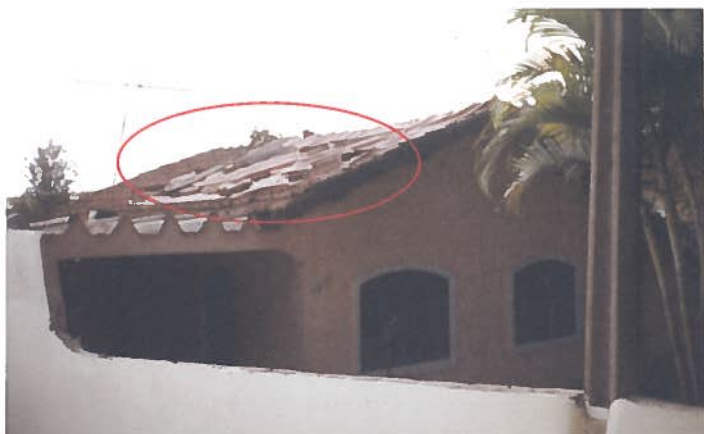
Foto 05 – Habitação 02: elevação frontal e cobertura (telhado com lona plástica para diminuir goteiras).
