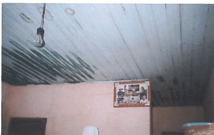
Foto 91 – Habitação 22: marcas de infiltrações no forro, oriundas da cobertura.
