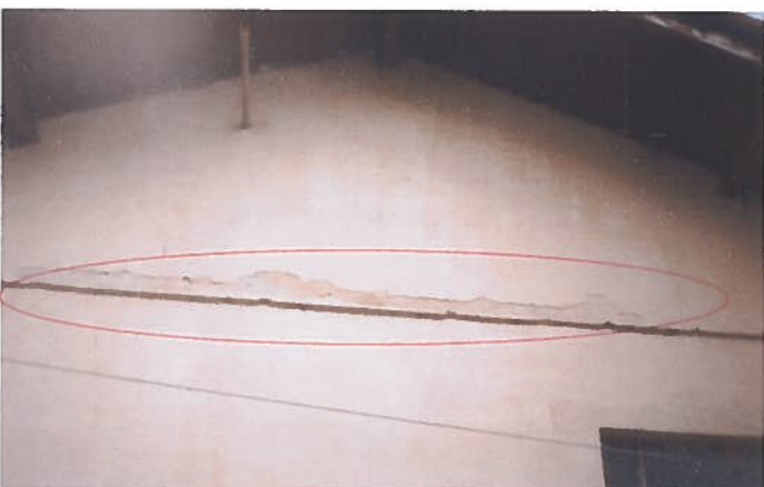
Foto 90 – Habitação 22: elevação posterior (destacamento da pintura e do reboco).
