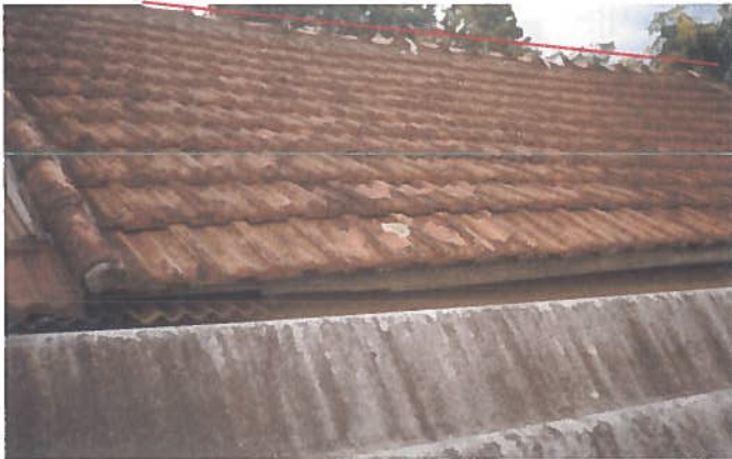
Foto 136 – Habitação pré-teste 03: Cobertura selada e beirais em mau estado de conservação.
