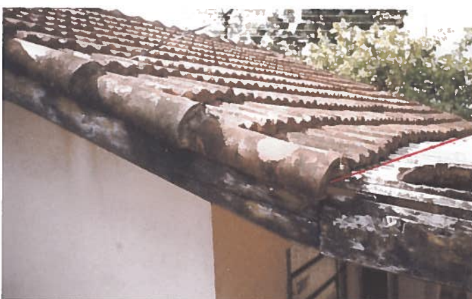
Foto 73 – Habitação 18: telhado original com ondulações e beirais em péssimo estado de conservação.
