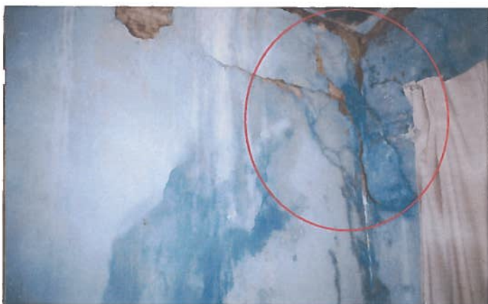
Foto 75 – Habitação 18: trincas na região de emenda, entre a parede original e a parede divisória (executada pelo morador).
