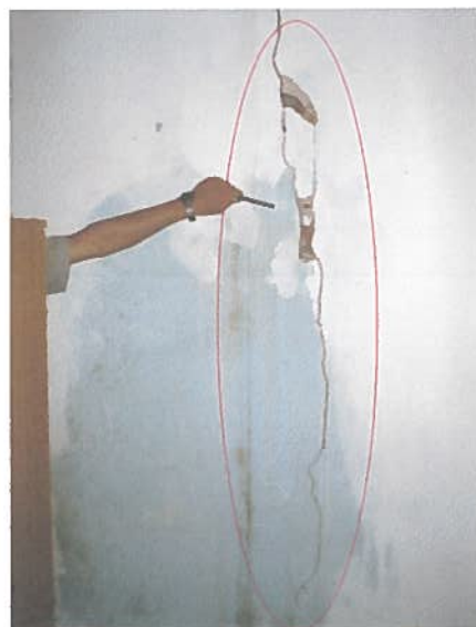
Foto 134 –Habitação pré-teste 02: Parede interna executada pelo morador, apresentando rachadura.
