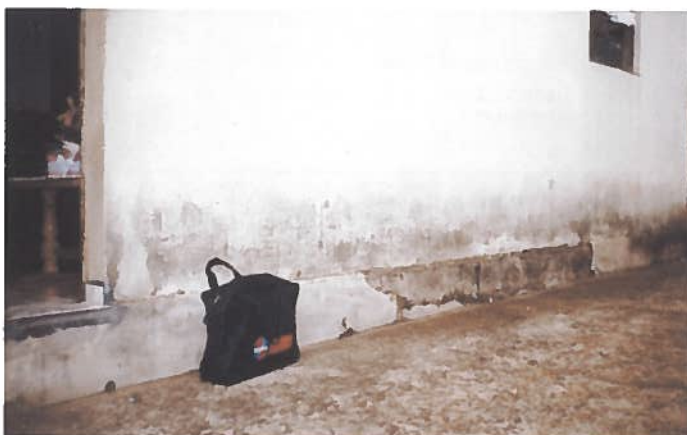
Foto 15 – Habitação 04: infiltração de umidade na base das paredes externas e destacamento do reboco.
