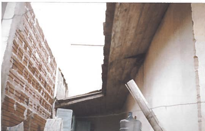
Foto 70 – Habitação 17: beirais sem nenhum tipo de pintura, o que propiciou a deterioração acelerada.
