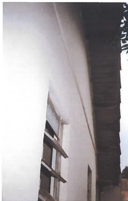
Foto 95 – Habitação 23: beirais em estado ruim (ausência de pintura para conservação).
