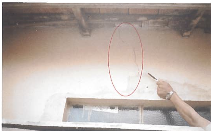
Foto 71 – Habitação 17: trincas em paredes, em função de recalques diferenciais entre, a parte original e a parte ampliada.
