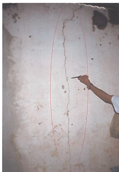
Foto 116 – Habitação 28: trinca vertical em parede executada pelo morador.
