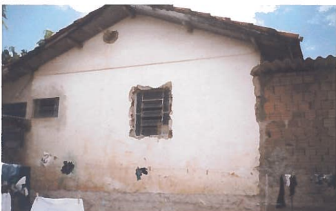
Foto 85 – Habitação 21: elevação posterior (destacamento do reboco na base da parede)
