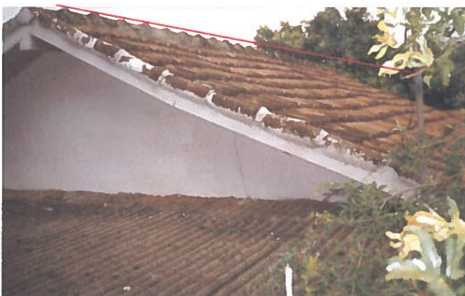
Foto 118 – Habitação 29: cobertura na parte original, empenada e selada.
