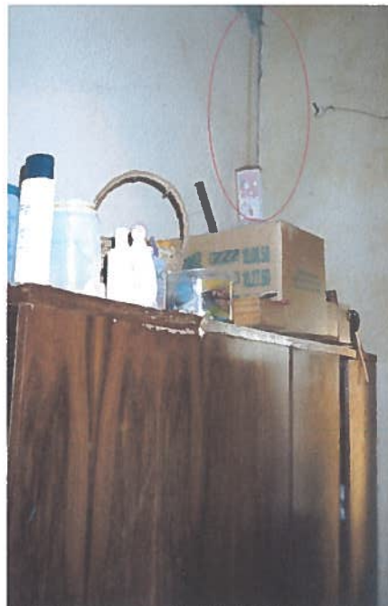
Foto 119 – Habitação 29: trincas na região de emenda (entre a parede original e a parede executada pelo morador – oitão posterior).
