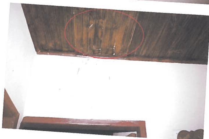
Foto 83 – Habitação 20: forro com marcas de infiltrações, oriundas de vazamentos nas instalações hidráulicas.
