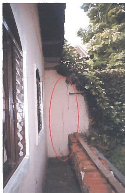
Foto 09 – Habitação 02: rachadura na junção entre o muro lateral e a construção.
