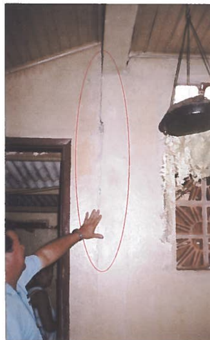
Foto 51 – Habitação 12: rachadura em parede (na emenda entre a parte original e a parte ampliada).
