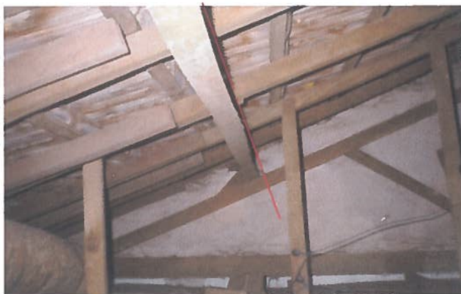
Foto 137 – Habitação pré-teste 03: Estrutura da cobertura com terça empenada.
