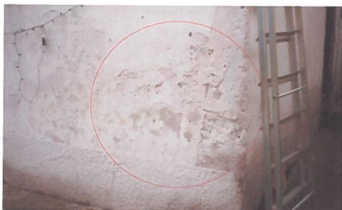
Foto 102 – Habitação 25: elevação frontal (parede apresentando destacamento do reboco).
