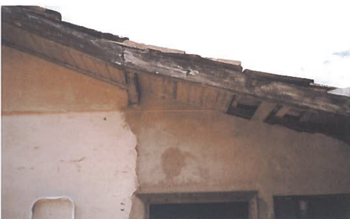
Foto 86 – Habitação 21: vistas e forros dos beirais sem pintura (péssimo estado de conservação).
