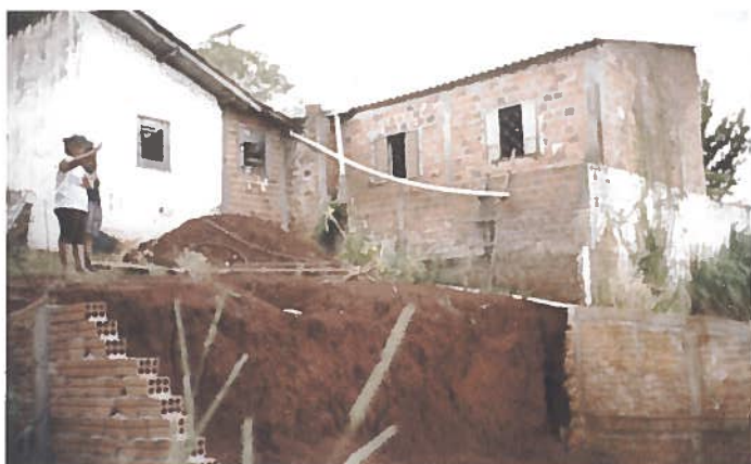
Foto 45 – Habitação 11: corte acentuado no terreno dos fundos, sem muro de contenção ou arrimo (risco de deslizamento).
