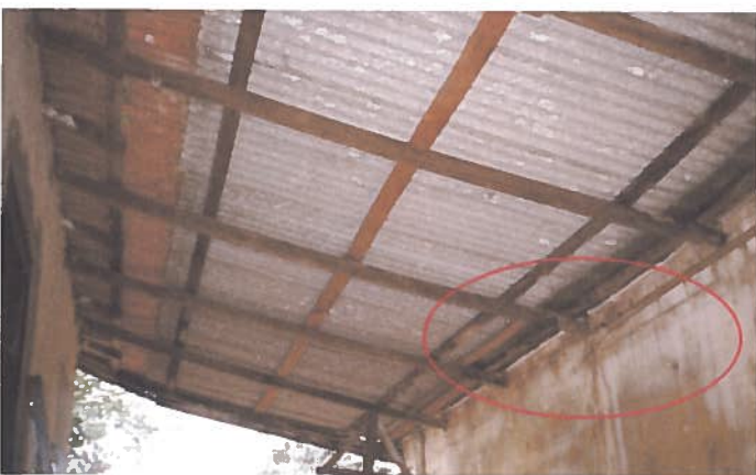
Foto 74 – Habitação 18: calha da parte ampliada sub-dimensionada, gerando marcas de infiltração de água na parede.
