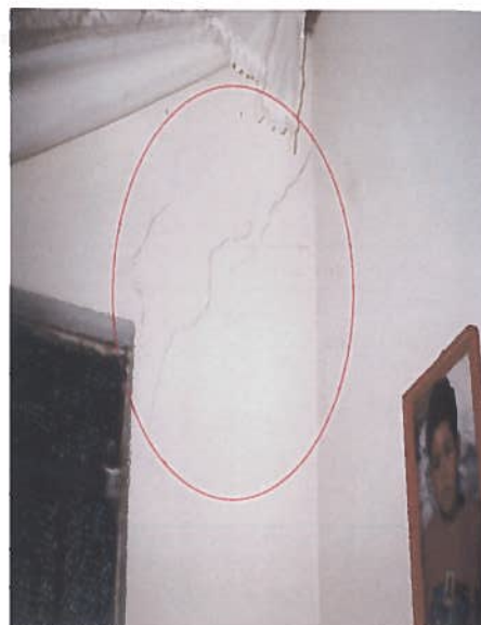
Foto 24 – Habitação 06: surgimento de trincas em função da falta de contra-verga.
