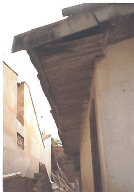
Foto 115 – Habitação 28: beirais em péssimo estado (na parte ampliada pelo morador).
