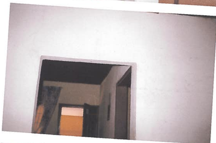
Foto 82 – Habitação 20: ausência de batente e guarnições em madeira.
