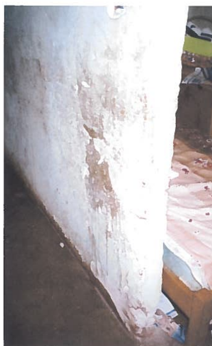
Foto 87 – Habitação 21: parede com reboco esfarelando (argamassa com dosagem inadequada).
