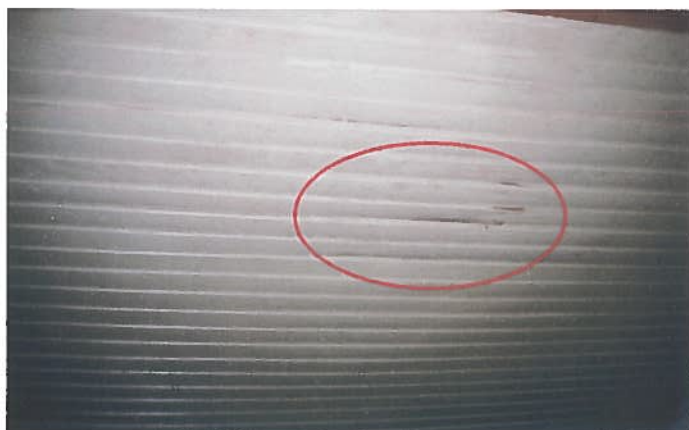
Foto 28 – Habitação 07: forro com marcas de infiltrações, oriundas de vazamentos no telhado.
