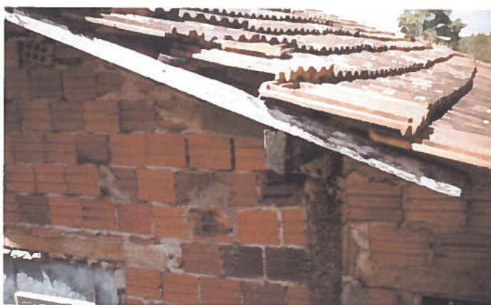
Foto 65 – Habitação 16: telhado com ondulações e beirais em péssimo estado de conservação.
