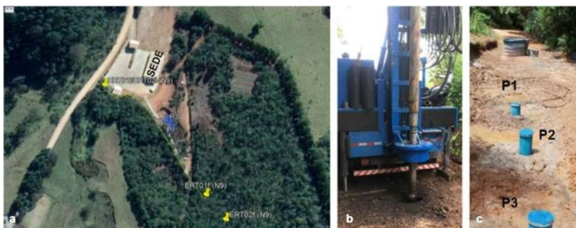
Figura 6.4 - Posicionamento dos poços P1, P2 e P3 com 63, 26 e 10 m de profundidade, respectivamente, próximos à sede do Projeto Conservador de Águas, assim como as linhas ERT01 e ERT02 que foram utilizadas para escolher os locais das perfurações (A). Sistema de perfuração rotopneumático (B) e situação final dos poços (C).
