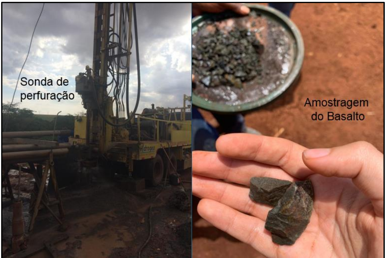
Figura 65 – Sonda de perfuração em operação e amostragem do basalto do Sistema Aquífero Serra Geral (SASG).
