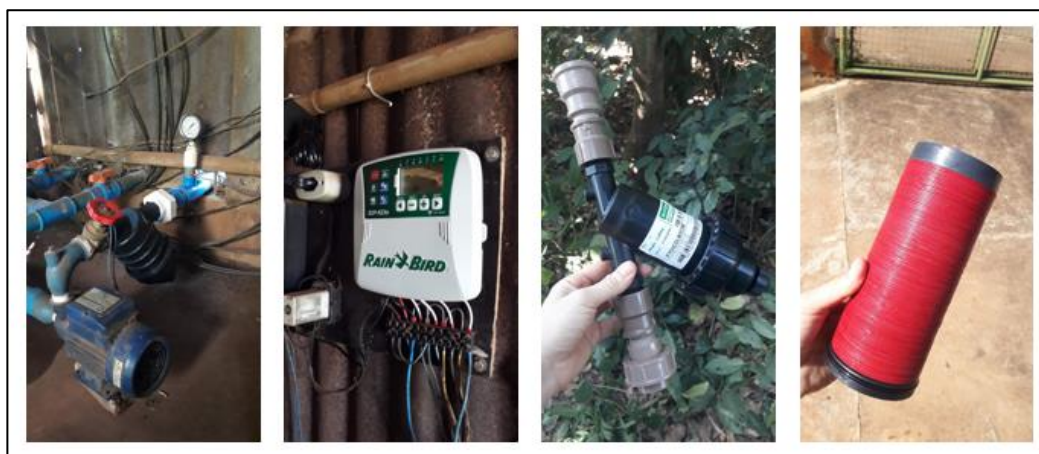
Figura 3. Demonstração de alguns componentes utilizados no sistema de irrigação: bomba, filtros e controlador automático.
