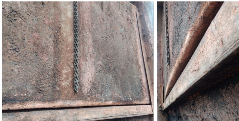
Figura 24. Empenamento da tampa traseira.
