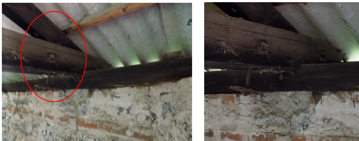
FIGURA 43: Oxidação e deslizamento de parafuso.
