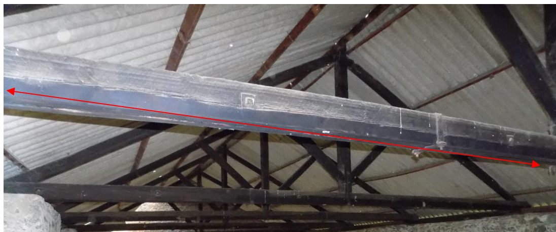
FIGURA 44: Banzo inferior com rachadura em toda a sua dimensão longitudinal.
