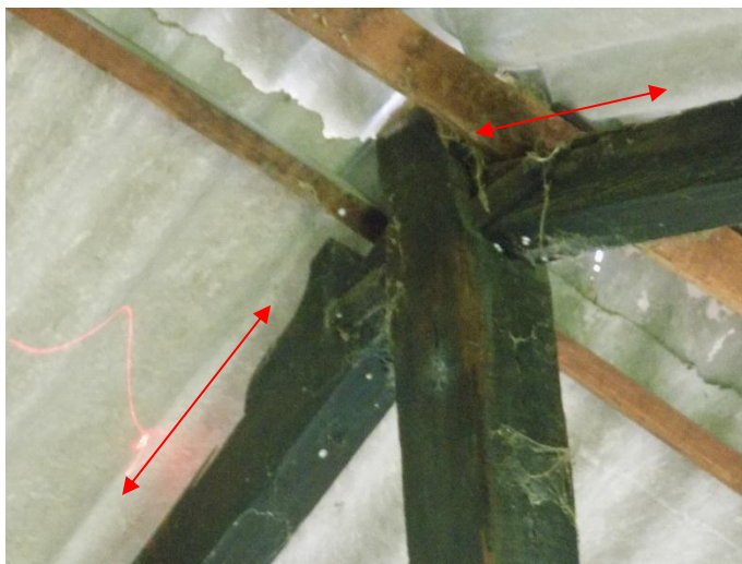
FIGURA 45: Deslizamento de banzos superiores devido a movimentação das peças
