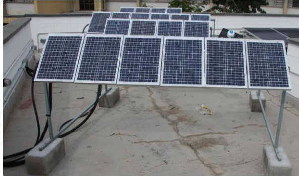
Figura 3.15 – Módulos posicionados para a calibração em conjunto com o piranômetro.
