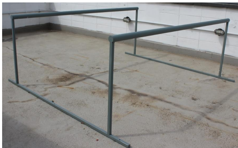
Figura 3.4 – Suporte dos módulos fotovoltaicos.
