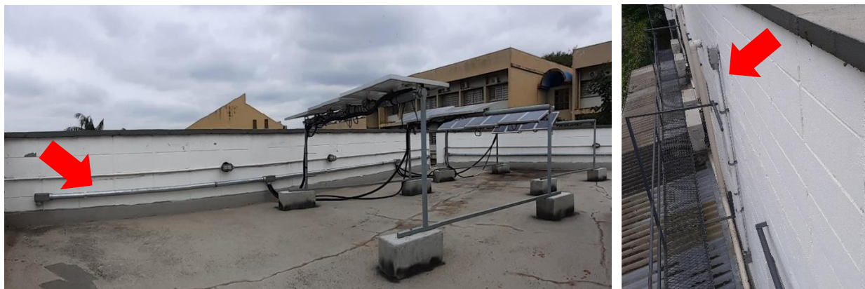
Figura 3.7 – Eletrodutos instalados no terraço destacados pela seta vermelha
