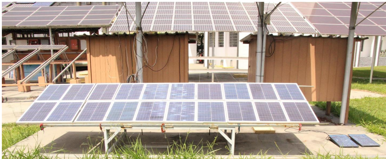
Figura 3.2 – Módulos fotovoltaicos expostos à radiação solar
