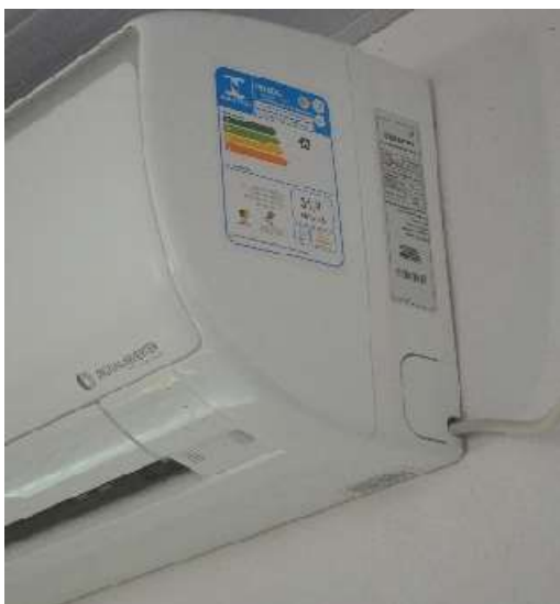
Figura 5 – Placa de identificação do condicionador de ar.
