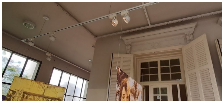
Figura 27 – Fotografia das canaletas metálicas que sustentam os painéis.
