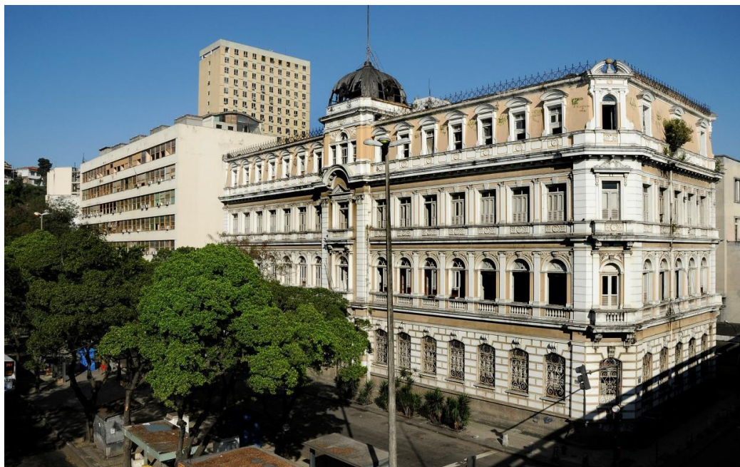
Figura 13 -- Registro fotográfico do conjunto arquitetônico que seria reformado para receber o museu. Destacam-se os pontos de degradação aparentes na cobertura (ruínas) e na fachada (pichações, esquadrias danificadas e arbustos crescendo na varanda), século XXI.
