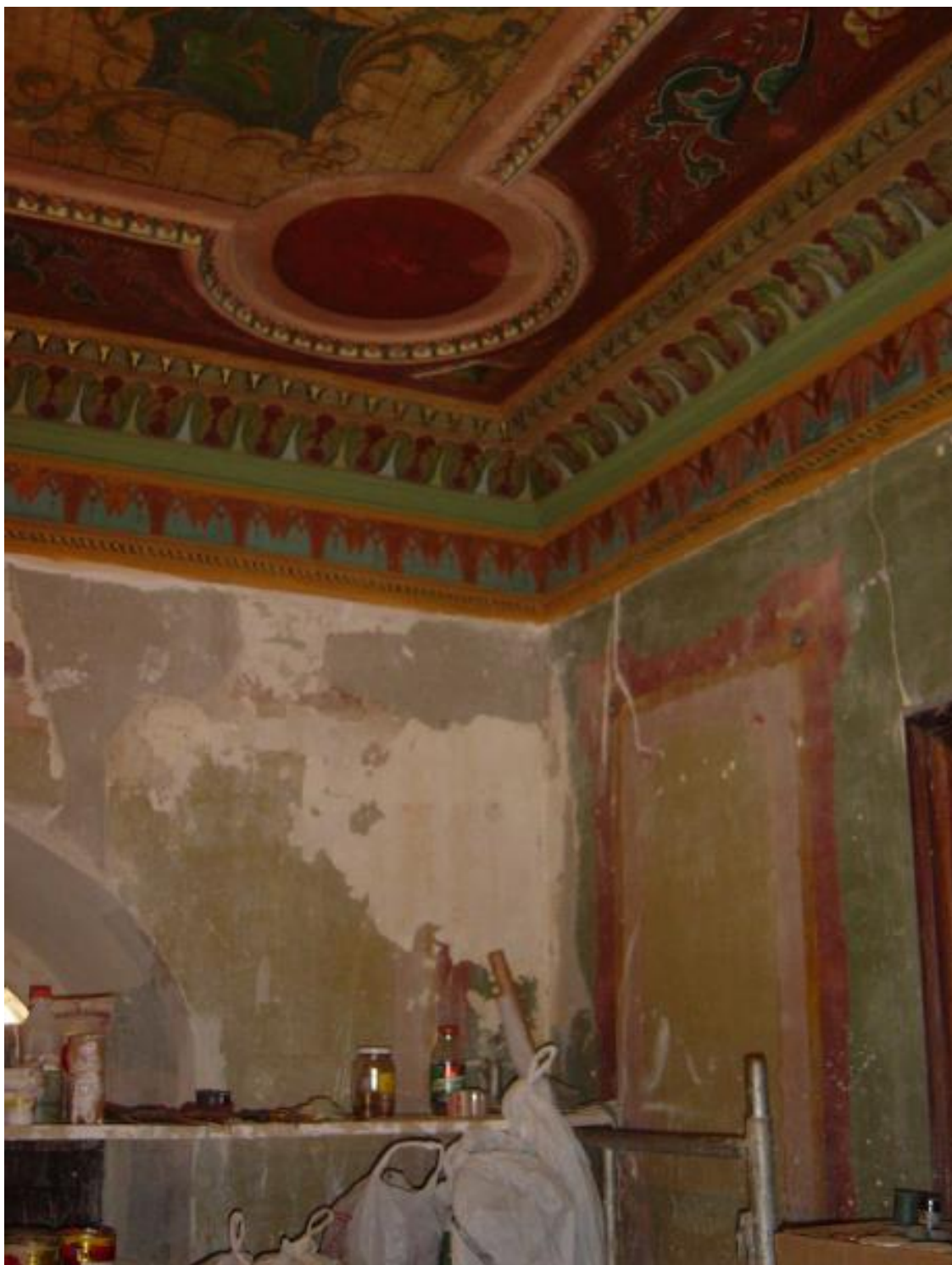
Figura 57: Detalhes das pinturas murais em recuperação: paredes e forro Foto: Fernanda Craveiro Cunha, 2005. Fonte: Acervo fotográfico do Museu do Tribunal de Justiça de São Paulo.
