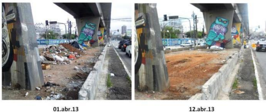
Figura 54 – Duas imagens mostrando o antes e depois da remoção do entulho no canteiro central do MAAU.
