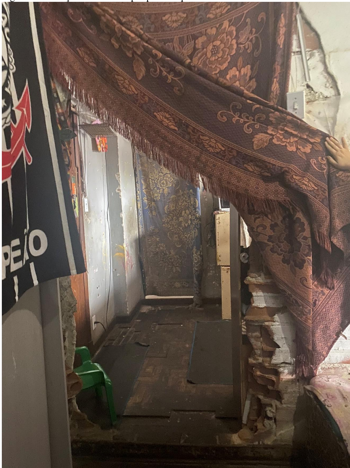
Figura 3.22: Junção de cômodos por paredes quebradas.
