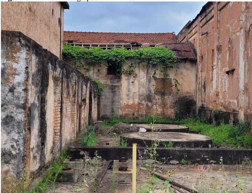
Figura 30 – Anexos do galpão I em ruínas
