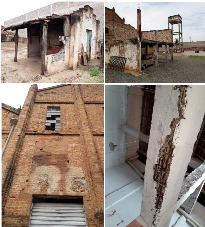
Figura 113 – Elementos depredados e degradados
