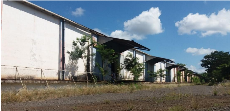
Figura 186 – Fachada lateral do armazém do IBC II
