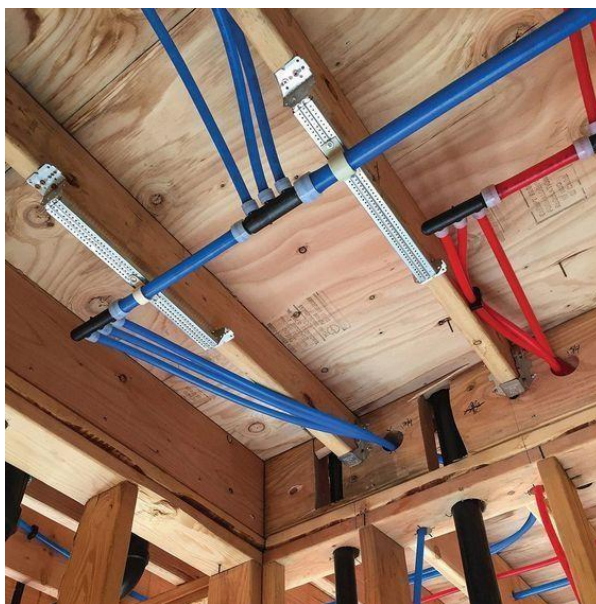
Figura 14: Sistemas elétricos e hidráulicos embutidos nas paredes
