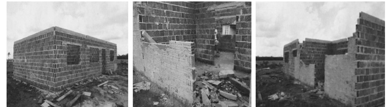
Figura 10. Problemas identificados em 17 casas pela ação do vento
