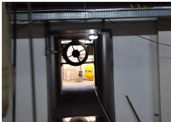
Figura 40: Ventilador nas galerias
