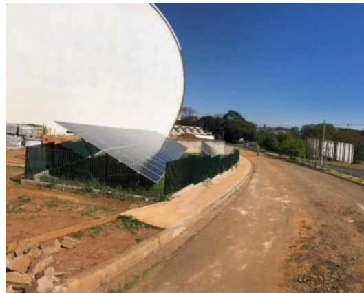
Figura 51: Usina solar fotovoltaica
