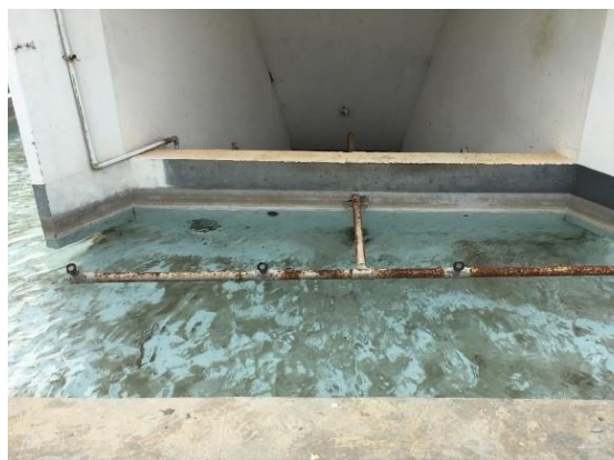
Figura 69: Danificação dos espelhos d'água
