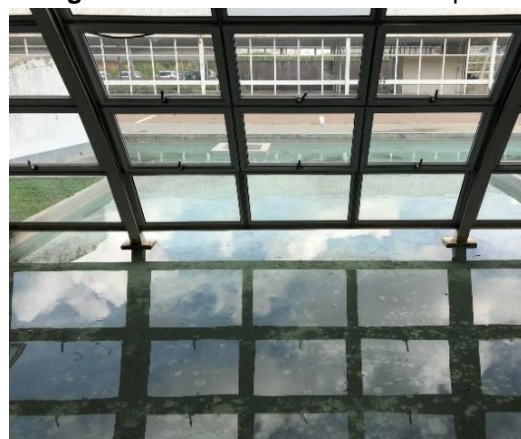
Figura 46: Aberturas fixas no rodapé
