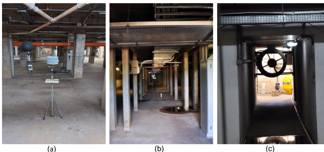
Figura 15: Subsolo técnico (ambiente 1)
