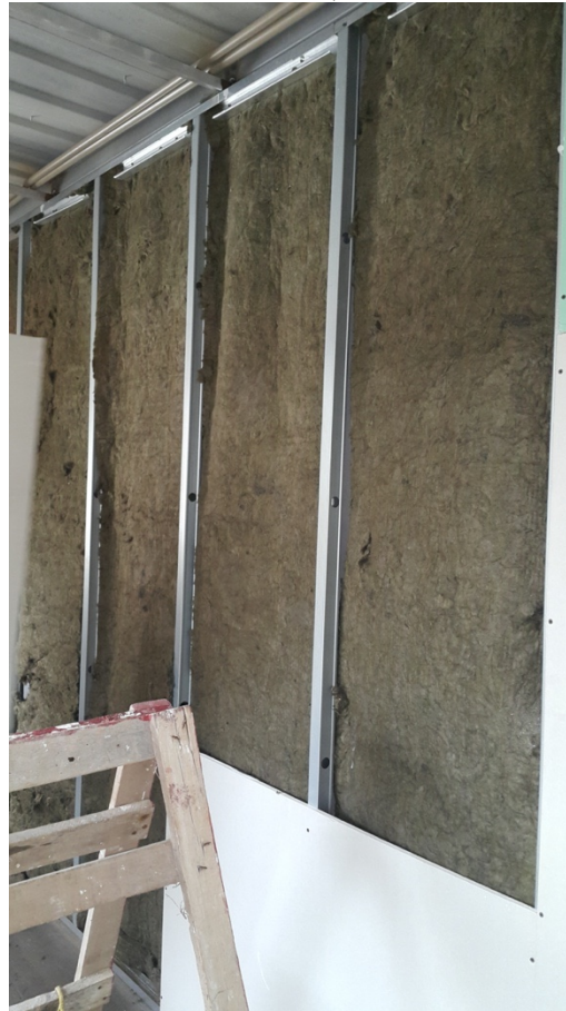
Imagem 2.34 – Lã de rocha em parede de contêiner. Fonte: Autor, 2019.
