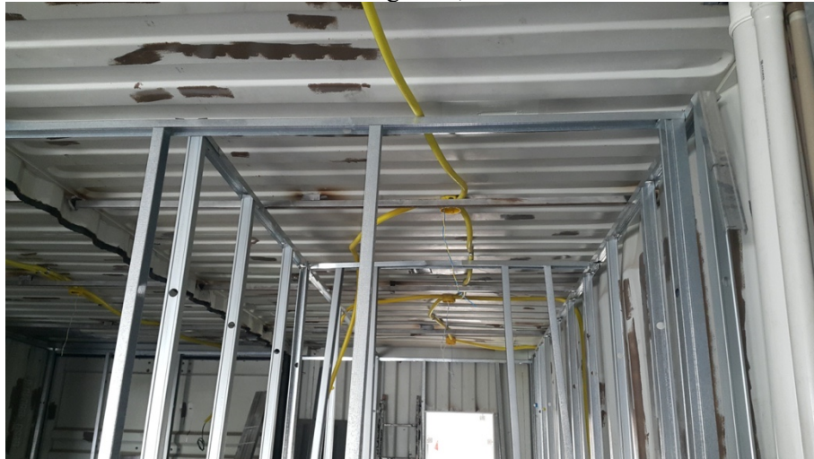
Imagem 2.31 – Passagem de tubulações de elétrica. Fonte: Agnaldo, 2019.
