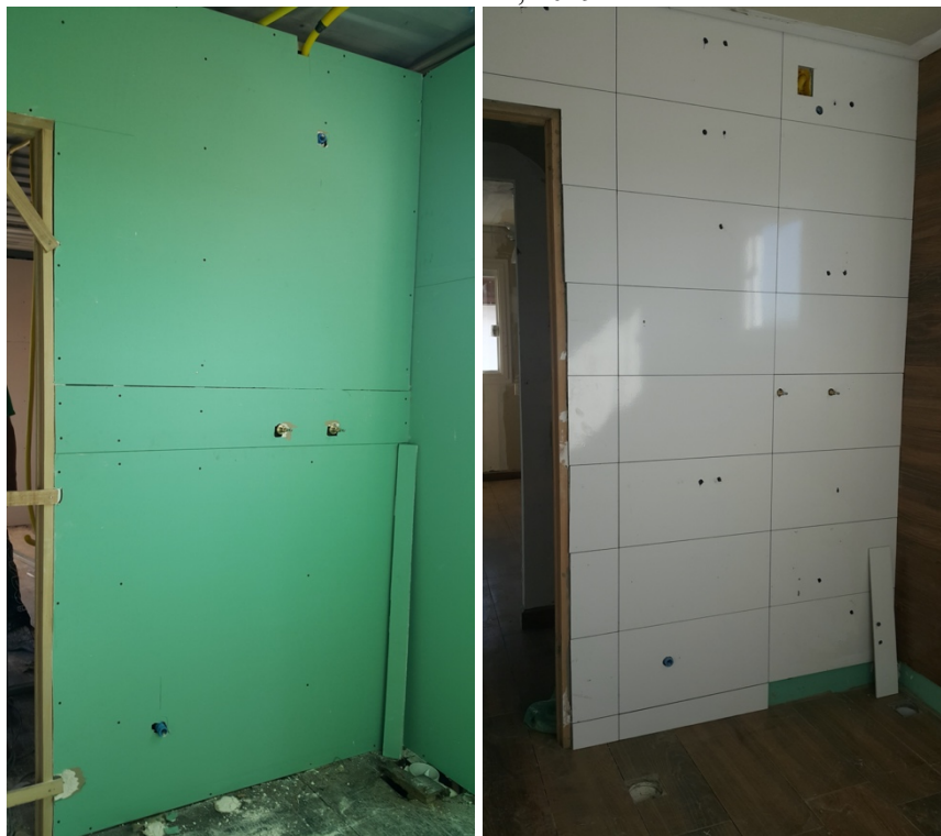
Imagem 2.38 – Revestimentos internos em paredes de ambientes húmidos em contêiner. Fonte: Autor, 2019.
