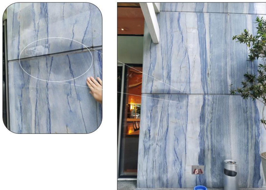
Figura 17 - Fachada de prédio revestido em rocha ornamental evidenciando manchamento causado pela absorção de água
