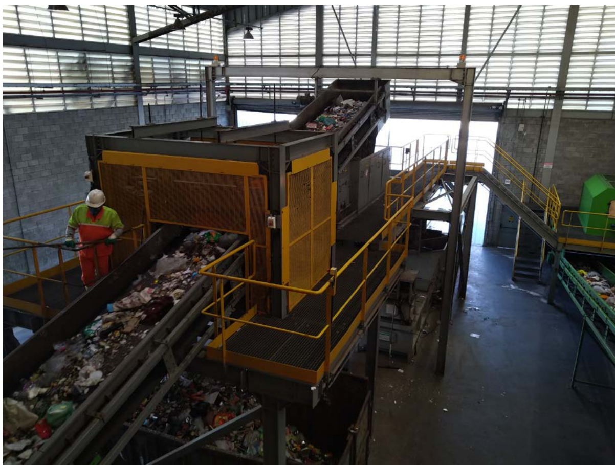
FOTO 14 - Sensores magnéticos e por indução e rejeito
