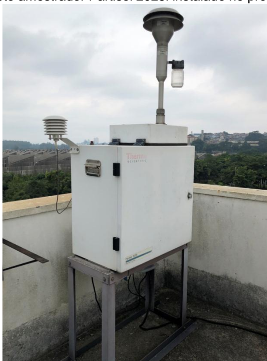
Figura 10 Foto amostrador Partisol 2025i instalado no prédio da EACH.
