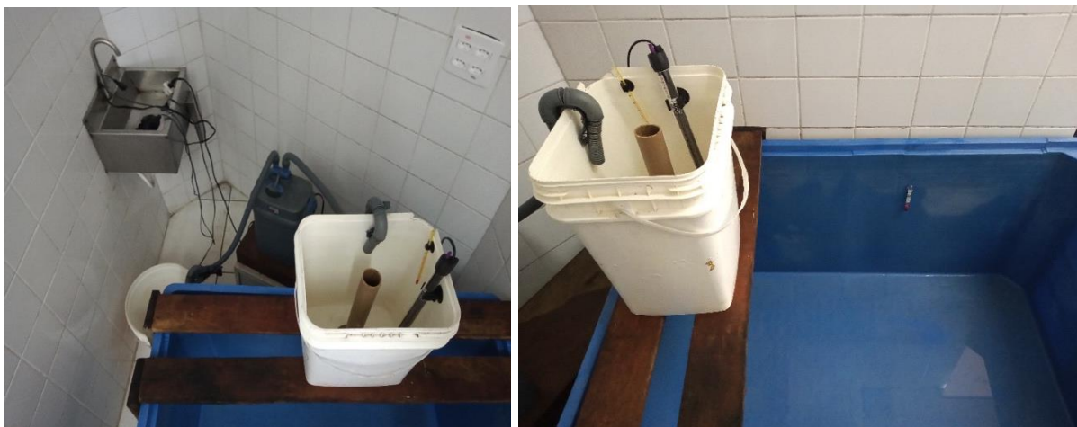
Figura 9 - Sistema de recirculação de água aquecida com registro da temperatura.
