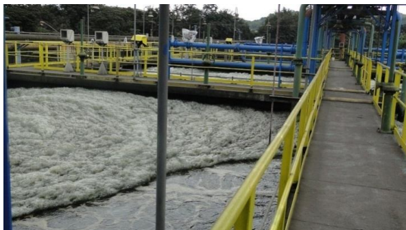
Figura 4 – Estação de tratamento biológico de lodo ativado.
