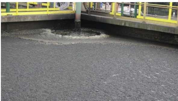
Figura 8 – Estação de tratamento biológico de lodo ativado – tanque de recebimento de efluente
