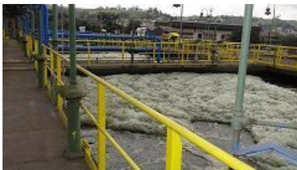
Figura 9 – Estação de tratamento biológico de lodo ativado – tanque de aeração
