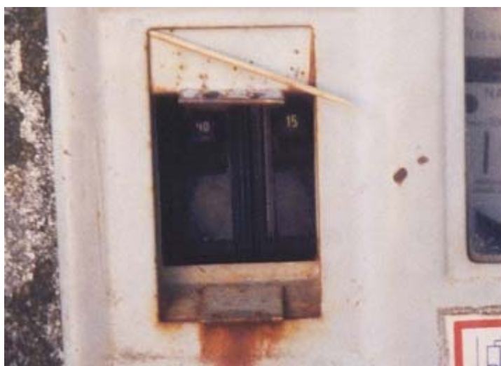
Figura 4: Dois disjuntores de entrada do controlador de demanda residencial
