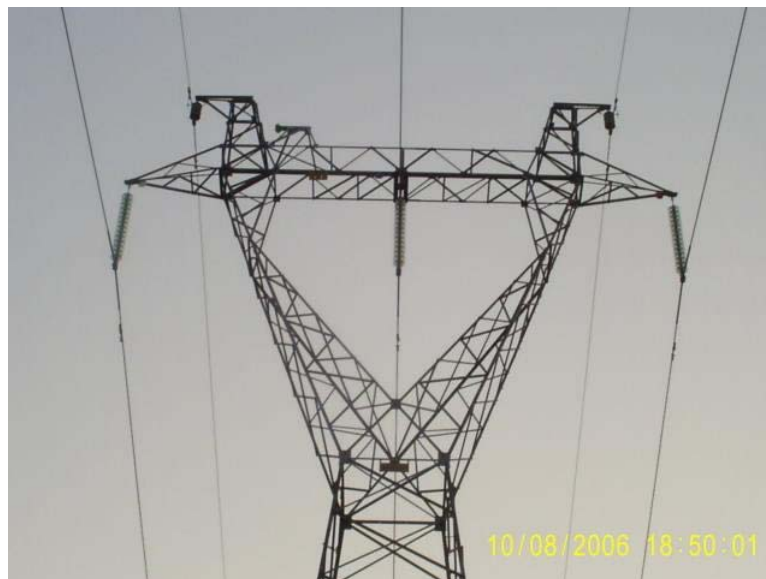
Figura 4.9: Geometria da cabeça da torre de suspensão simples da LT 230 kV com cabo PRE. Foto: José Ezequiel Ramos.
