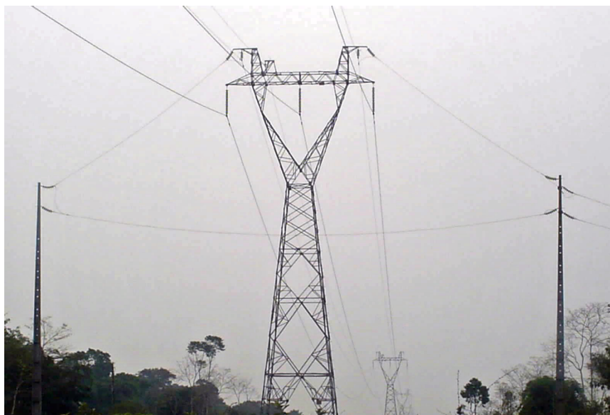
Figura 2.12 Torre de derivação dos cabos para-raios para a linha lateral
