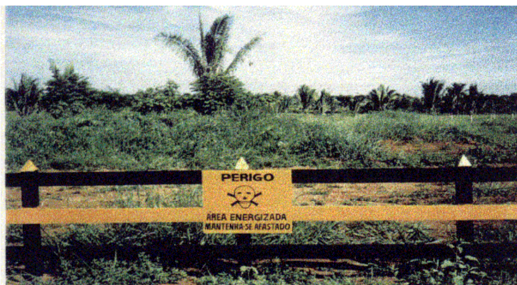
Figura 2.19 Cerca de proteção da malha independente - SE Ariquemes II
