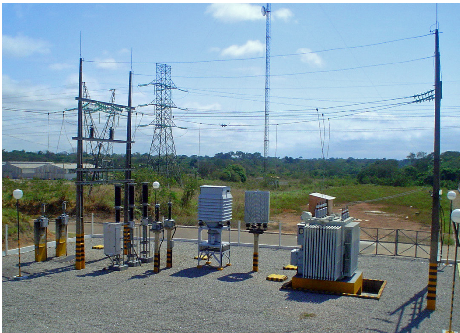
Figura 4.9 Pátio da subestação supridora do PRE, em Samuel
