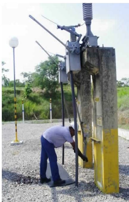
Figura 5.58 Operação de abertura da chave de aterramento rápido na subestação do PRE, em Samuel, para permitir que a linha PRE seja reenergizada
