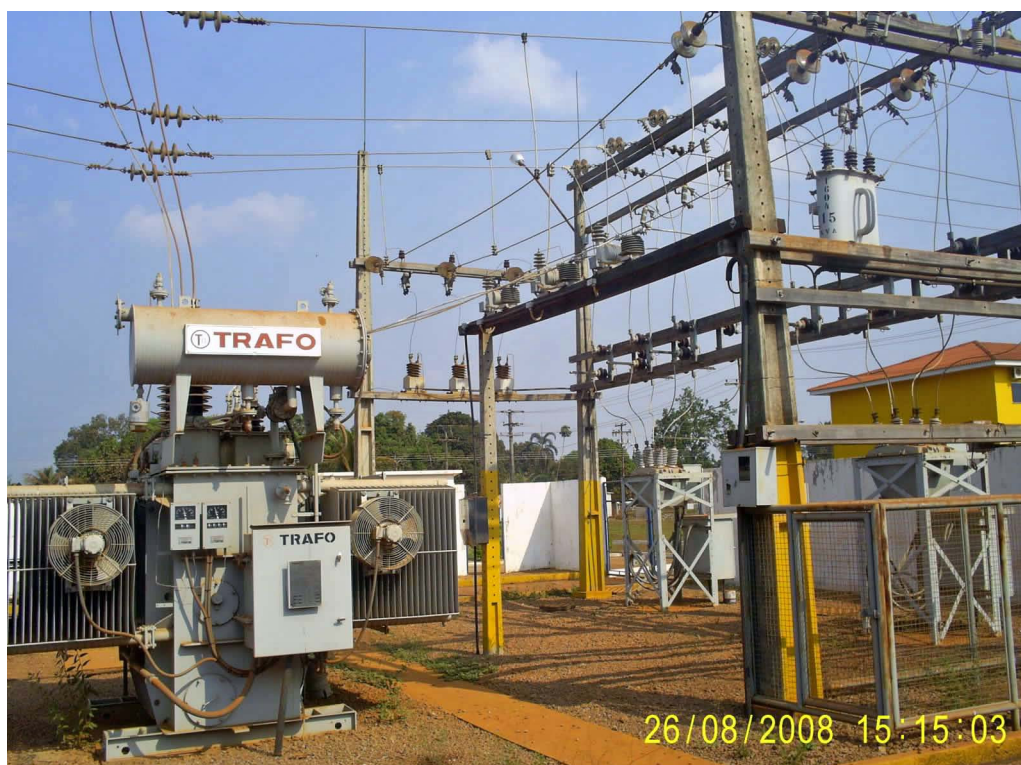
Figura 4.10 Pátio da subestação distribuidora do PRE, em Itapuã do Oeste
