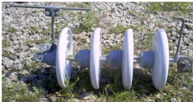
Figura 2.13 Cadeia de isoladores rígida, com dispositivo centelhador
