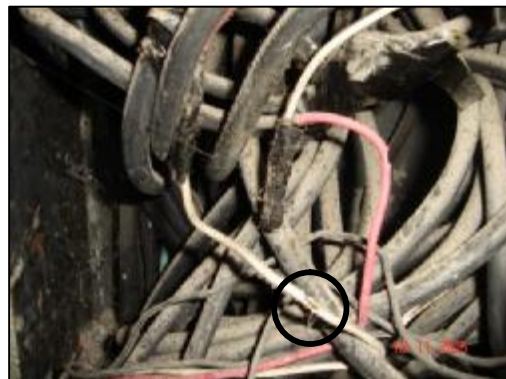
Fotografia 13 - Detalhe da fiação descascada.
