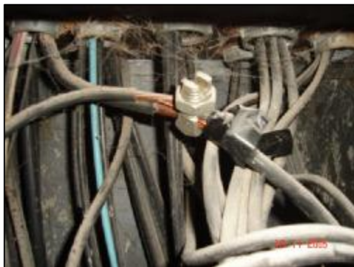
Fotografia 12 - Detalhe da falta de isolante nos conectores.
