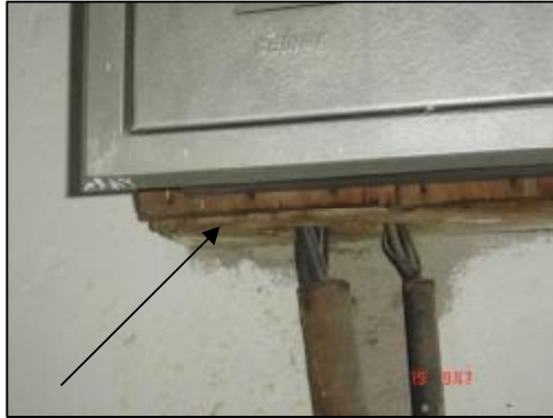
Fotografia 8 - Quadro de distribuição, montado sobre base de madeira, propiciando riscos de incêndio.
