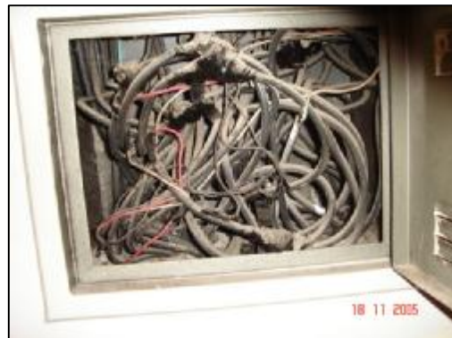
Fotografia 11 - Vista geral de caixa de passagem.
