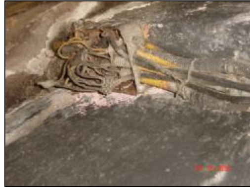
Fotografia 9 - Instalação exposta e em más condições.
