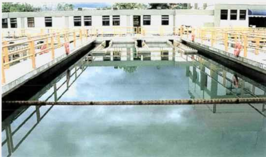
FIGURA 26 – Tanque de decantação com saída de água para a fase de filtragem.
