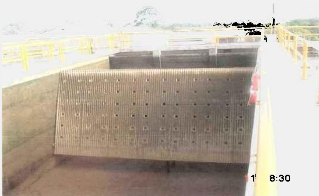
FIGURA 24 – Decantador da ETA de Registro, com o lodo depositado.
