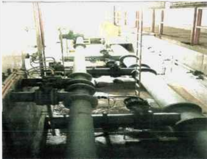
FIGURA 28 - Saída dos tanques de filtração para cloração e abastecimento.
