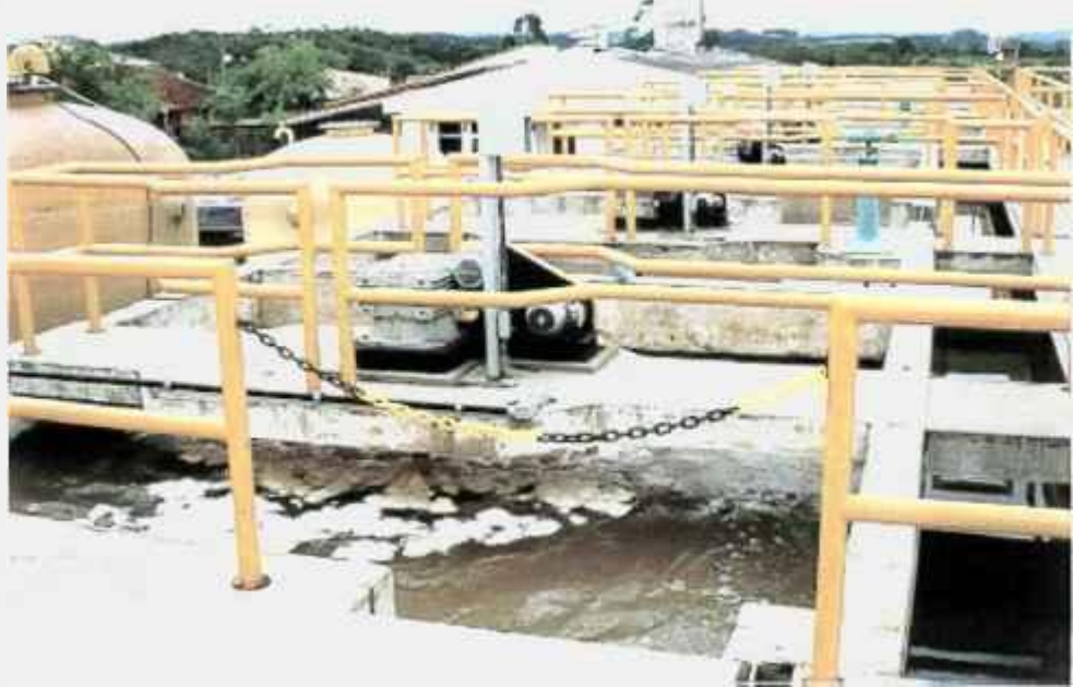
FIGURA 23 – Tanques de floculação e coagulação, ETA de Registro.
