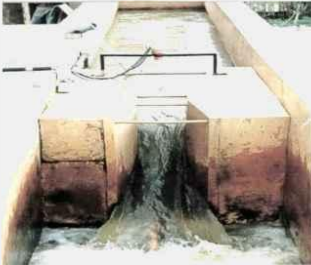
FIGURA 21 - Entrada de água na ETA de Registro, proveniente da estação de captação.
