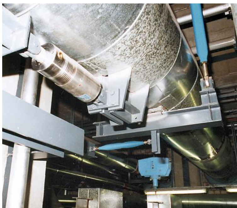
FIGURA 2 – Foto de dispositivo utilizado para restringir o possível chicoteamento de uma tubulação causado pelo seu rompimento.
