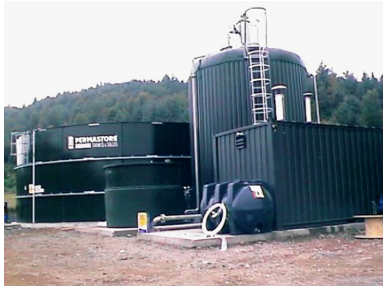
Figura 2: Planta de biogás (digestor anaeróbio, tanque de armazenamento de gás e tanque de armazenamento de resíduos).
